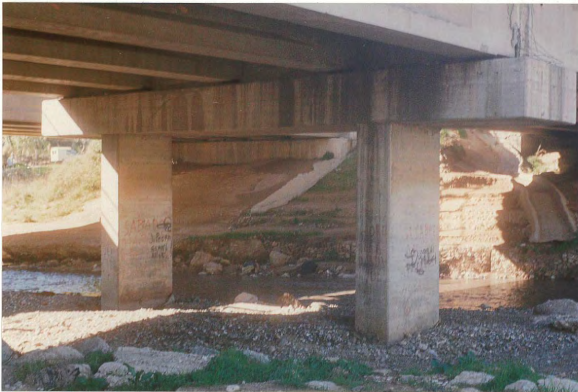
Figura 1. Altura alcanzada por las aguas en los pilares aguas arriba del puente de la autopista sobre el río Sec.
