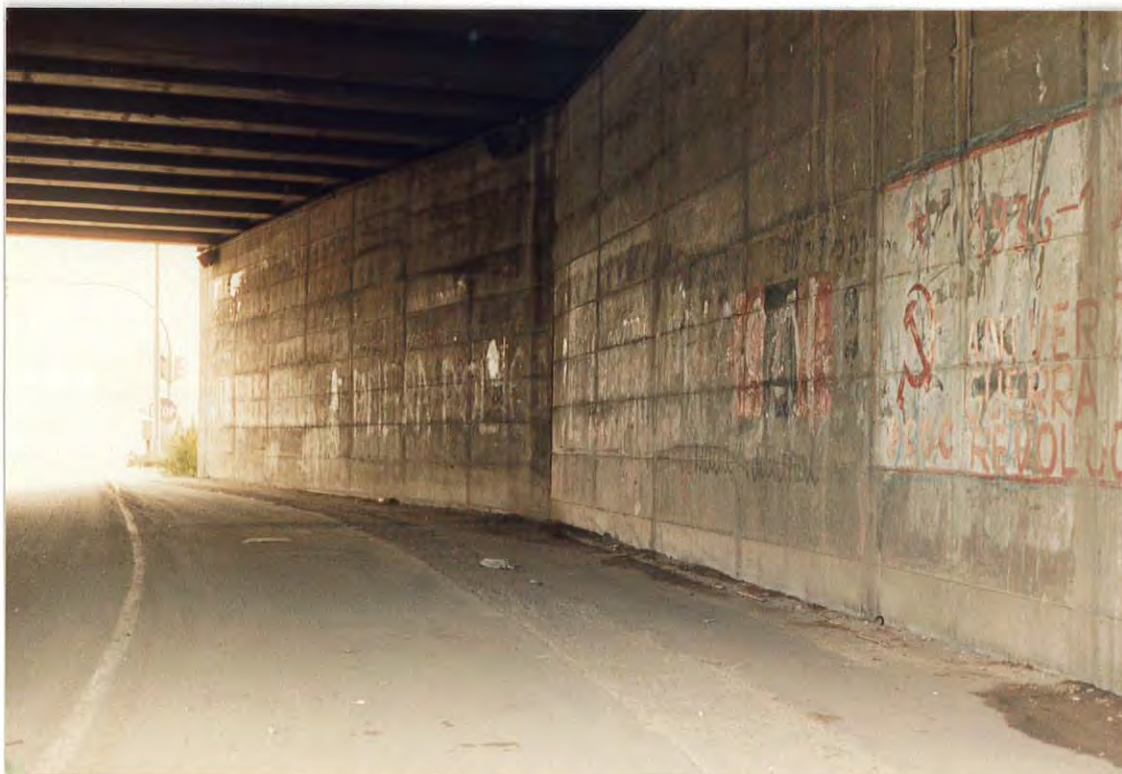
Figura 4. Puente de la Autovía de Castelldefels. Ramal en dirección a Barcelona, donde el agua alcanzó 15 cm de altura.
