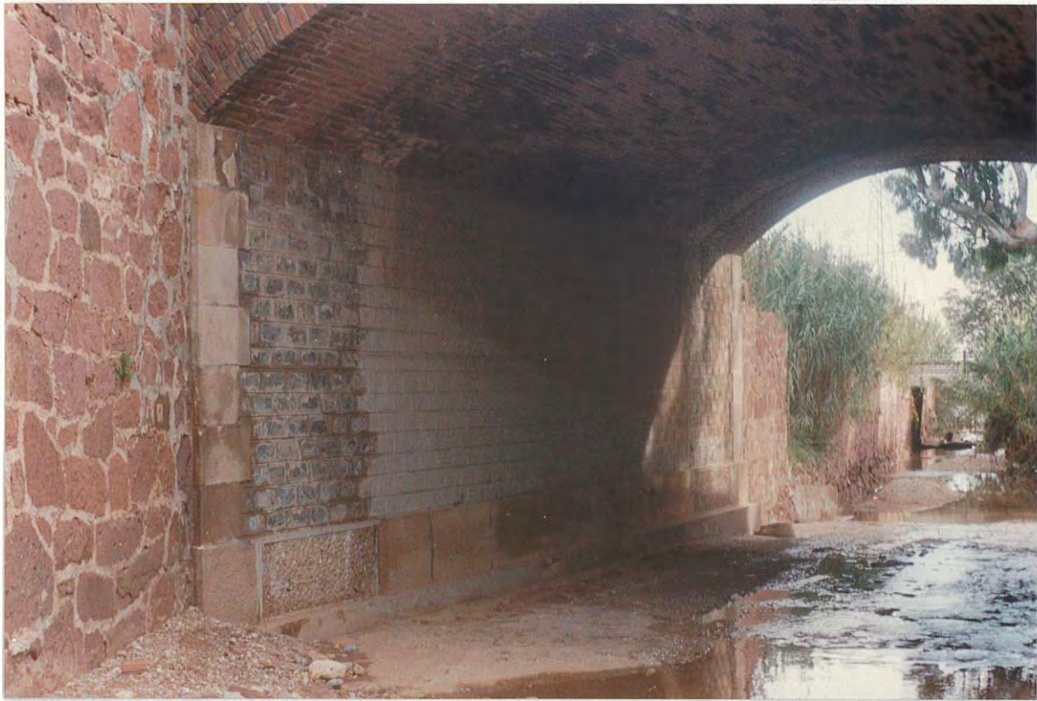
Figura 1 Vista desde aguas arriba del nivel alcanzado por las aguas en el estribo izquierdo del puente de la carretera C-245.
