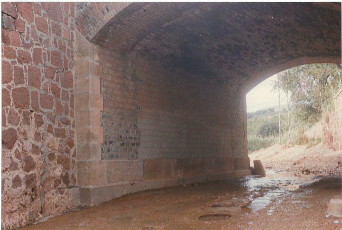
Figura 2. Vista desde aguas abajo del nivel alcanzado por las aguas en el estribo derecho del puente de la carretera C-245.
