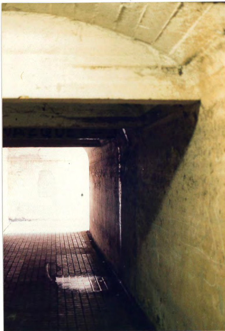
Figura 4. Vista parcial de la entrada norte del paso de peatones, donde se aprecia en nivel máximo alcanzado por las aguas.
