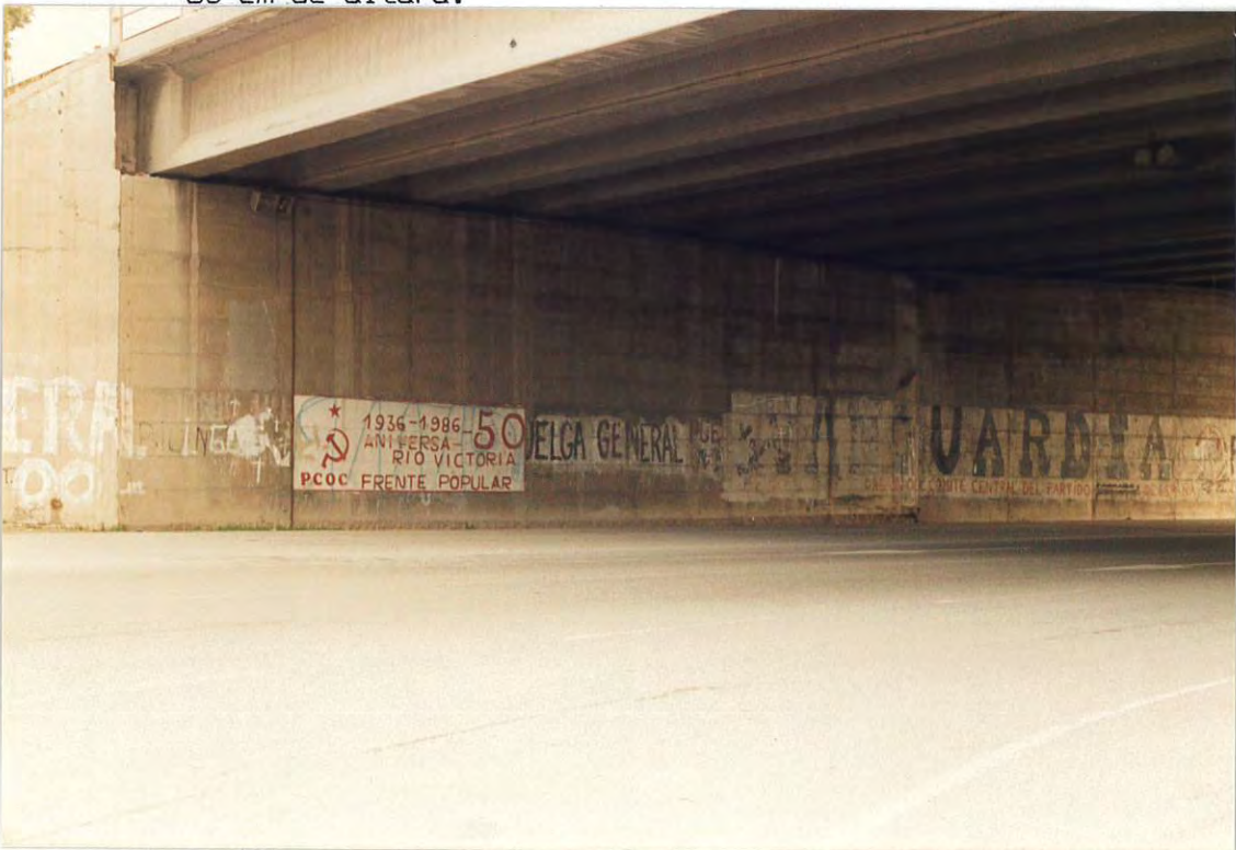
Figura 2. Puente de la Autovía de Castelldefels. Debido al peralte, el agua sólo alcanzó 30 cm de altura en la parte exterior de la curva.
