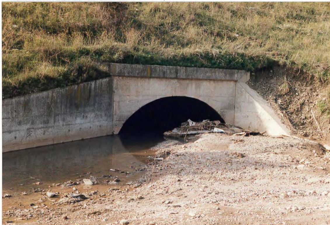
Figura 4. Sección aguas abajo de la riera, en el cruce con la carretera N-152, con los arrastres acumulados. El agua salía a gran presión, alcanzando cerca de 3 m de altura.
