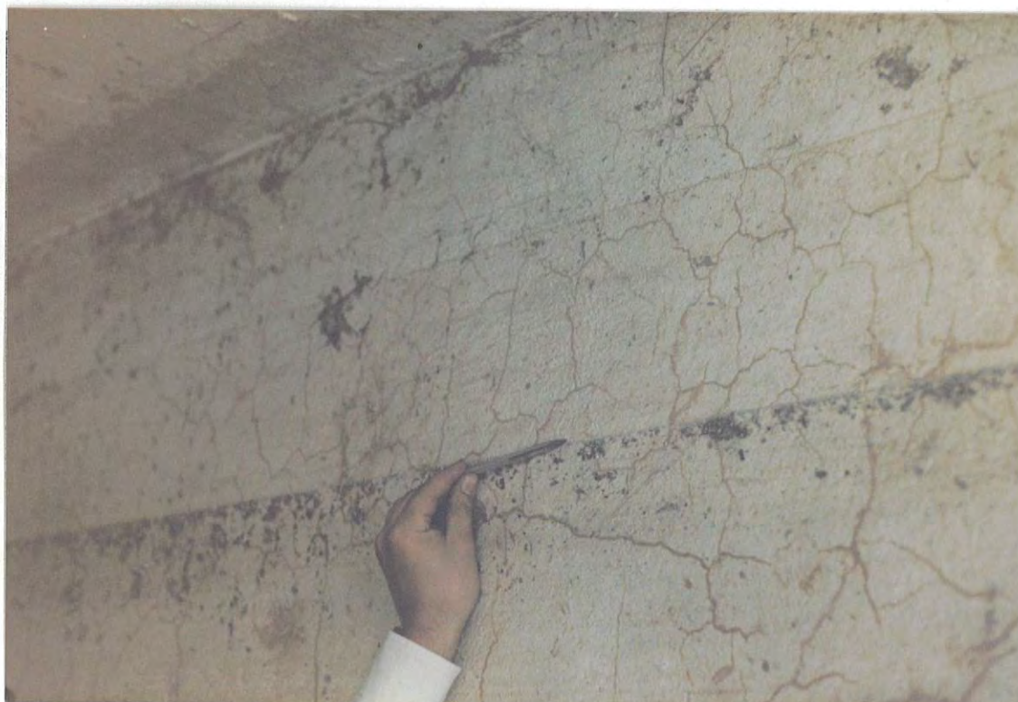
Figura 2. Detalle del nivel alcanzado por las aguas, superior a 2 m sobre el pavimento del paso de peatones.
