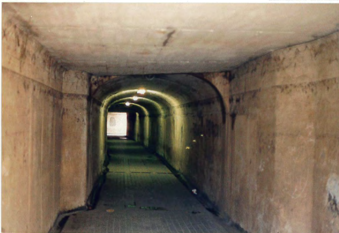
Figura 1. Vista general del paso de peatones bajo la calle de Santa Eulalia, donde se aprecia el nivel alcanzado por el agua.
