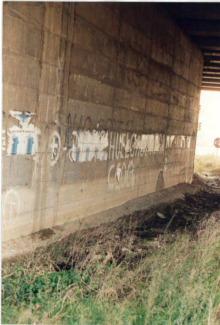
Figura 5. Cuneta del ramal en dirección a Barcelona, donde el agua alcanzó 45 cm de altura.
