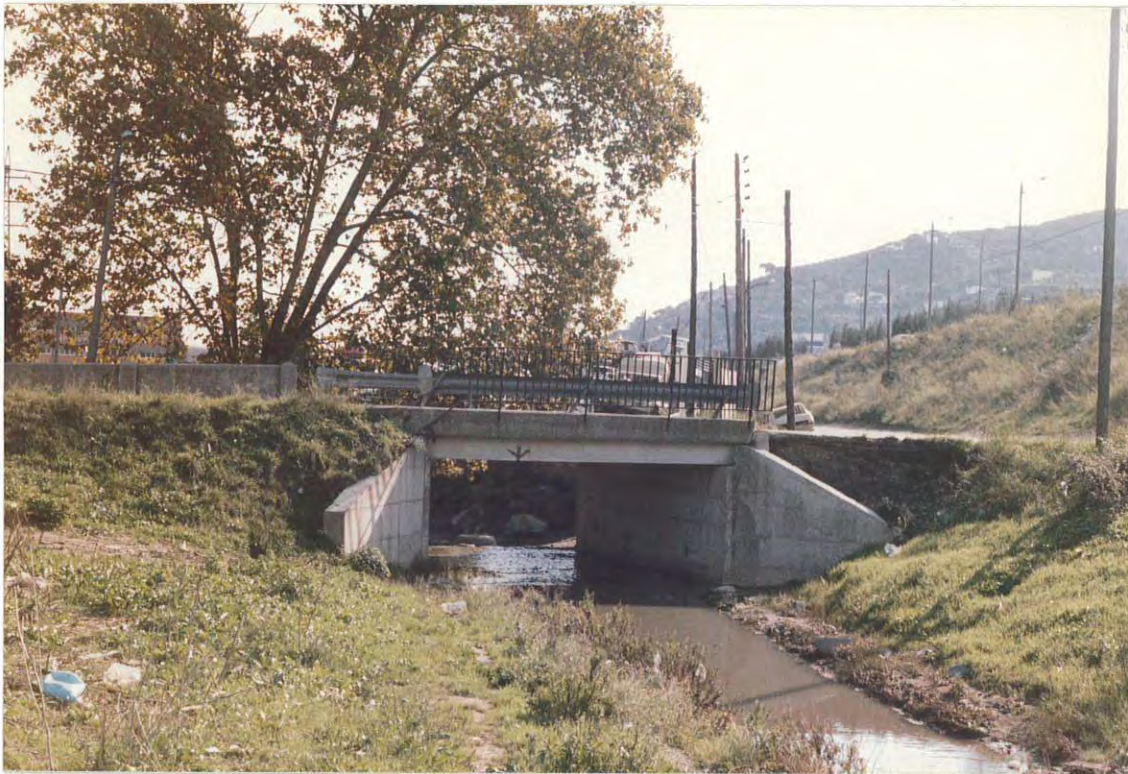
Figura 5. Avenida Sivatte a su paso sobre un puente de 2 m de altura libre. El agua sobrepaso el tablero del puente, discurriendo posteriormente por la propia calle.
