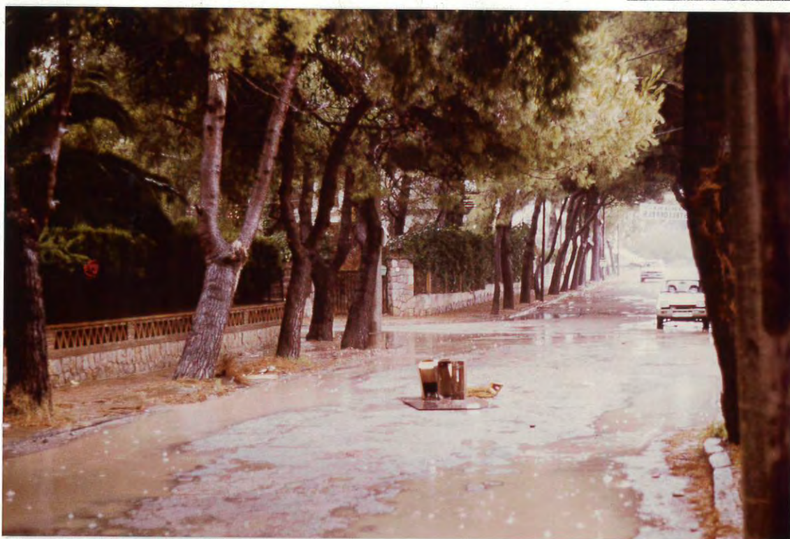
Figura 5. Señalización improvisada por los vecinos y plancha metálica sobre el socavón junto a un pozo de registro. La señalización sería arrastrada por la siguientes lluvias.
