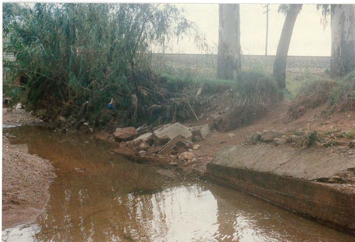
Figura 4. Detalle del mismo tramo de muro de encauzamiento tras las inundaciones de octubre de 1987.
