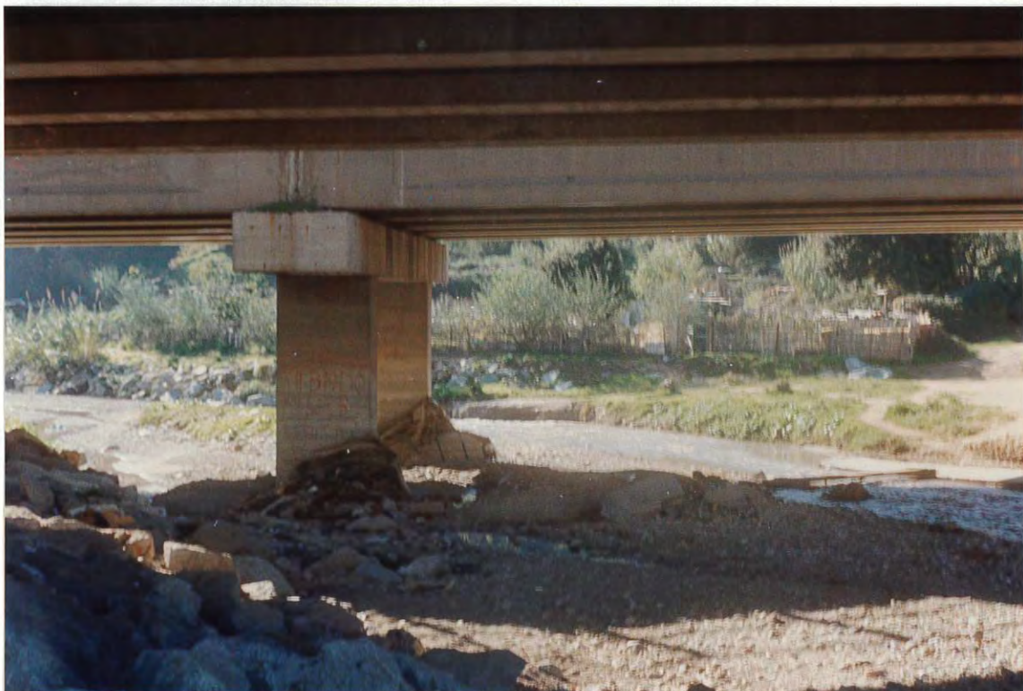
Figura 2. Altura alcanzada por las aguas en los pilares aguas abajo del puente de la autopista sobre el río Sec.
