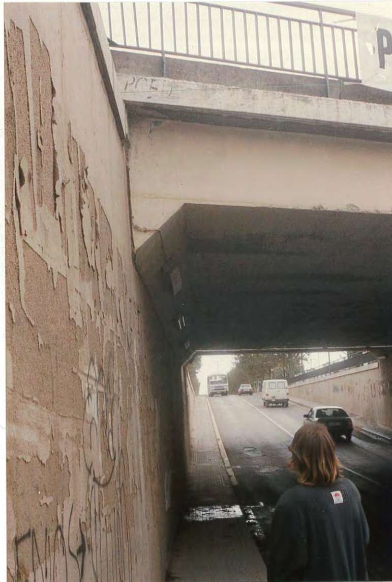
Figura 3. Paso de la avenida de la Pineda bajo el puente del ferrocarril Barcelona-Valencia. El agua alcanzó un altura próxima a 4,5 m.
