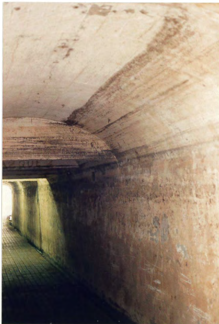
Figura 3. Vista parcial de la entrada sur del paso de peatones, donde se aprecian los diferentes niveles alcanzados por las aguas.
