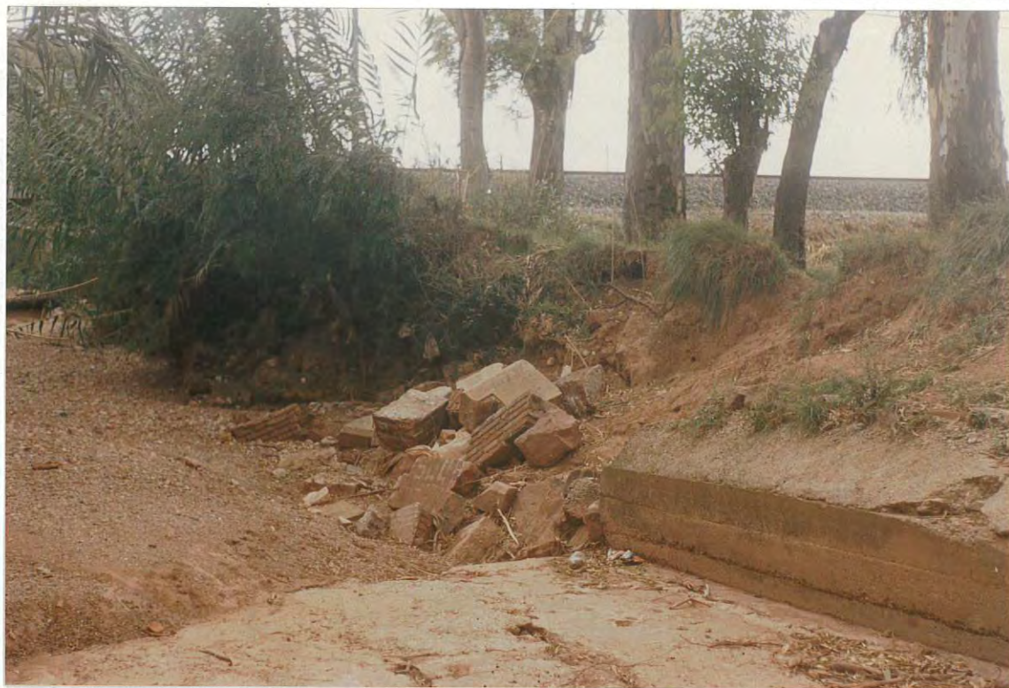
Figura 3. Detalle del muro de encauzamiento tras las inundaciones de noviembre de 1983.
