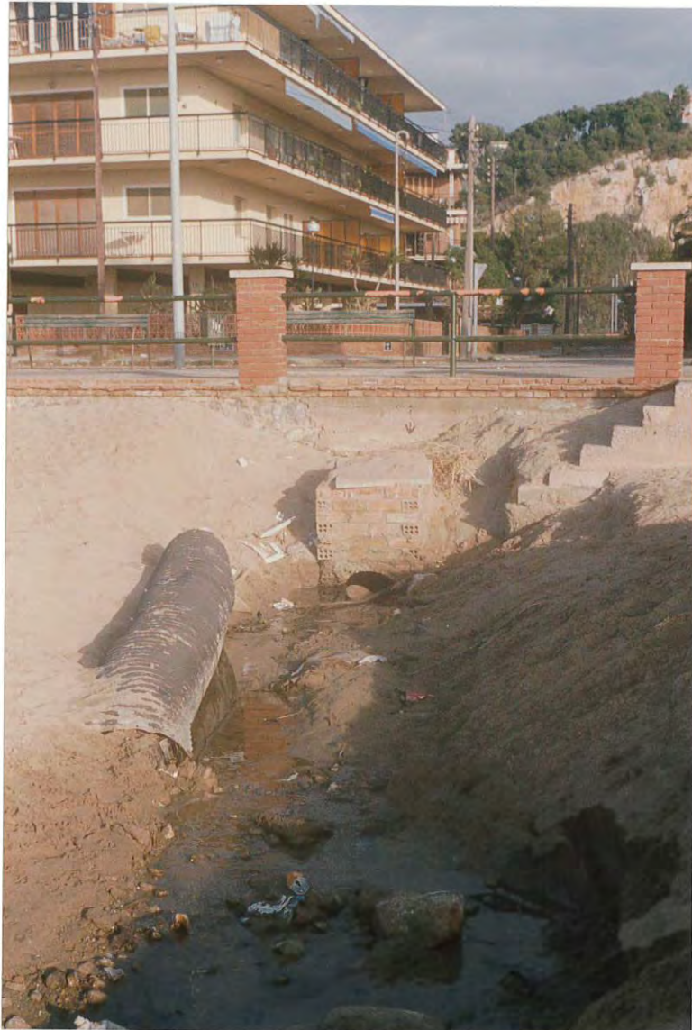
Figura 3. Detalle de la arqueta de desagüe, en el que se aprecia el tubo arrancado y la zanja practicada para facilitar la evacuación de las aguas.
