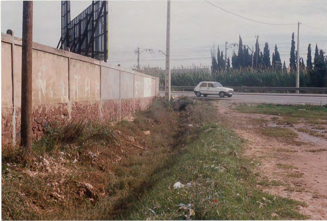
Figura 1. Vista general del estado de la acequia y de la tubería de cruce bajo la carretera C-245, destinadas a evacuar las aguas de escorrentía de la carretera de Begues.
