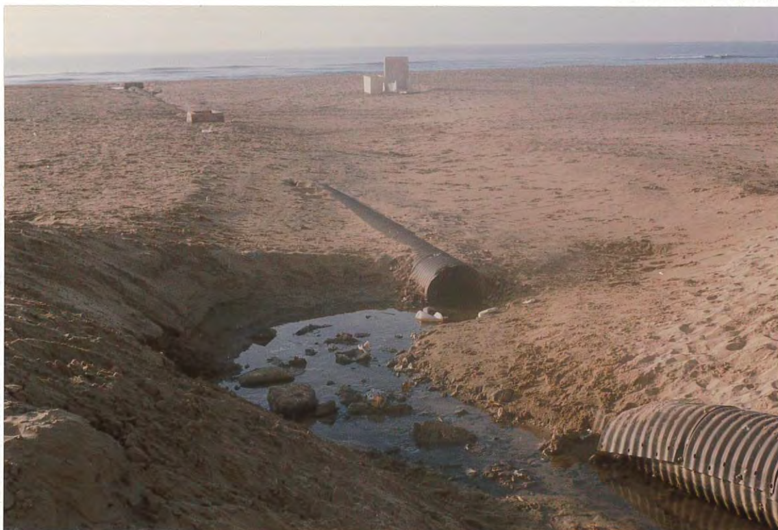
Figura 1. Estado de los conductos de desagüe, después de efectuadas las medidas de emergencia necesarias para permitir la evacuación de las aguas de escorrentía.
