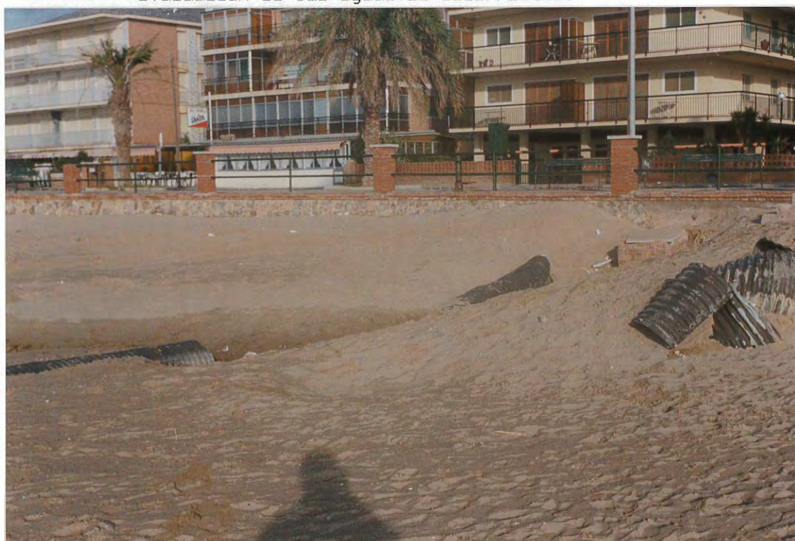
Figura 2. Vista general del estado de los conductos de desagüe en la playa de Castelldefels.
