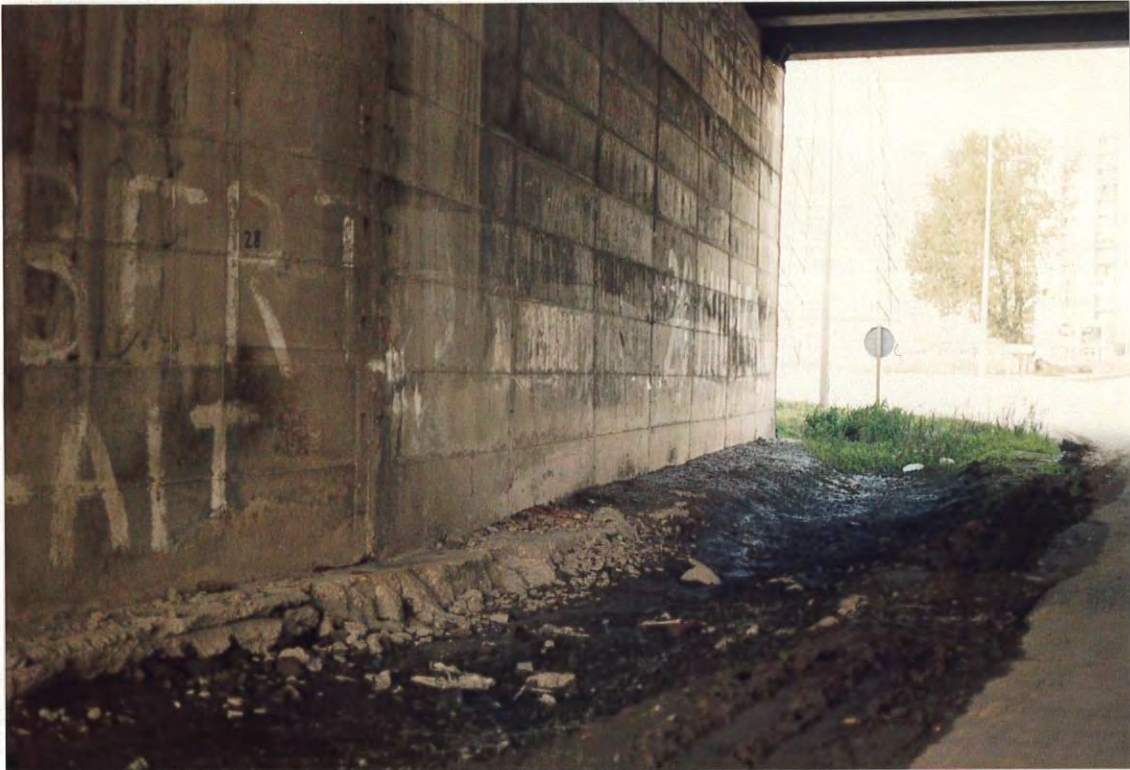
Figura 1. Puente de la Autovía de Castelldefels a su cruce con la Rambla La Marina. El agua descarnó la cuneta, alcanzando 85 cm de altura.
