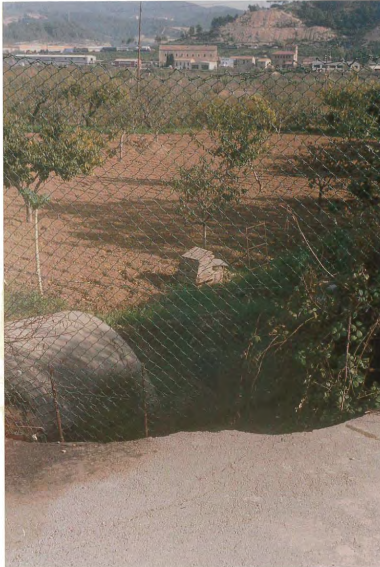
Figura 1. Extremo final del colector que constituye el tramo urbano de la riera Boter. Como puede observarse, la clave del conducto tiene una cota superior a la de los campos contiguos.
