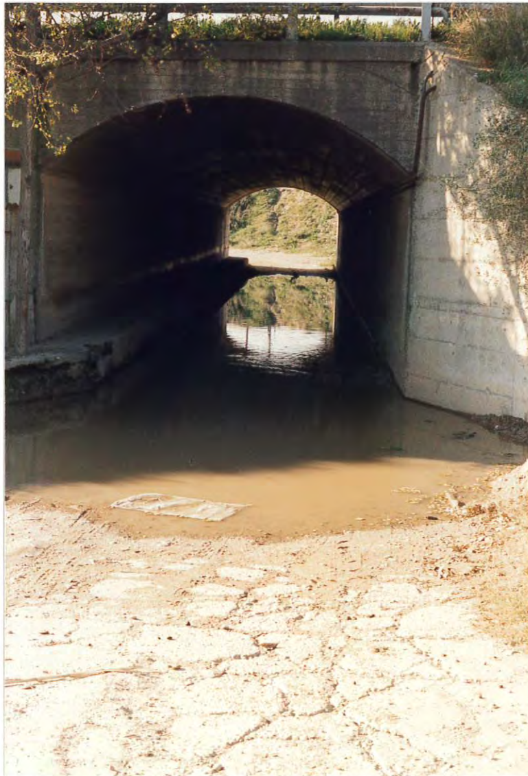
Figura 8. Túnel bajo la autopista A-2, en el término municipal de Sant Feliu de Llobregat. El paso de camiones destruyó el tubo de drenaje, haciendo que las aguas alcanzaran más de 1 m de altura.
