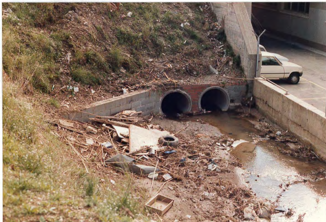
Figura 2. Colectores de paso del Torrent Tapioles junto a la primera de las instalaciones del Polígono Industrial Can Cuyás, en los que puede observarse la evidente reducción de sección.
