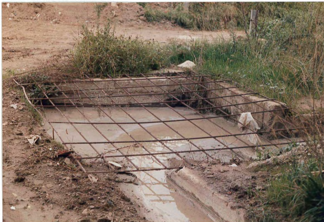
Figura 2. Desagüe existente en la calle Moratin bajo el puente del ramal de la autopista A-19 en dirección Barcelona.
