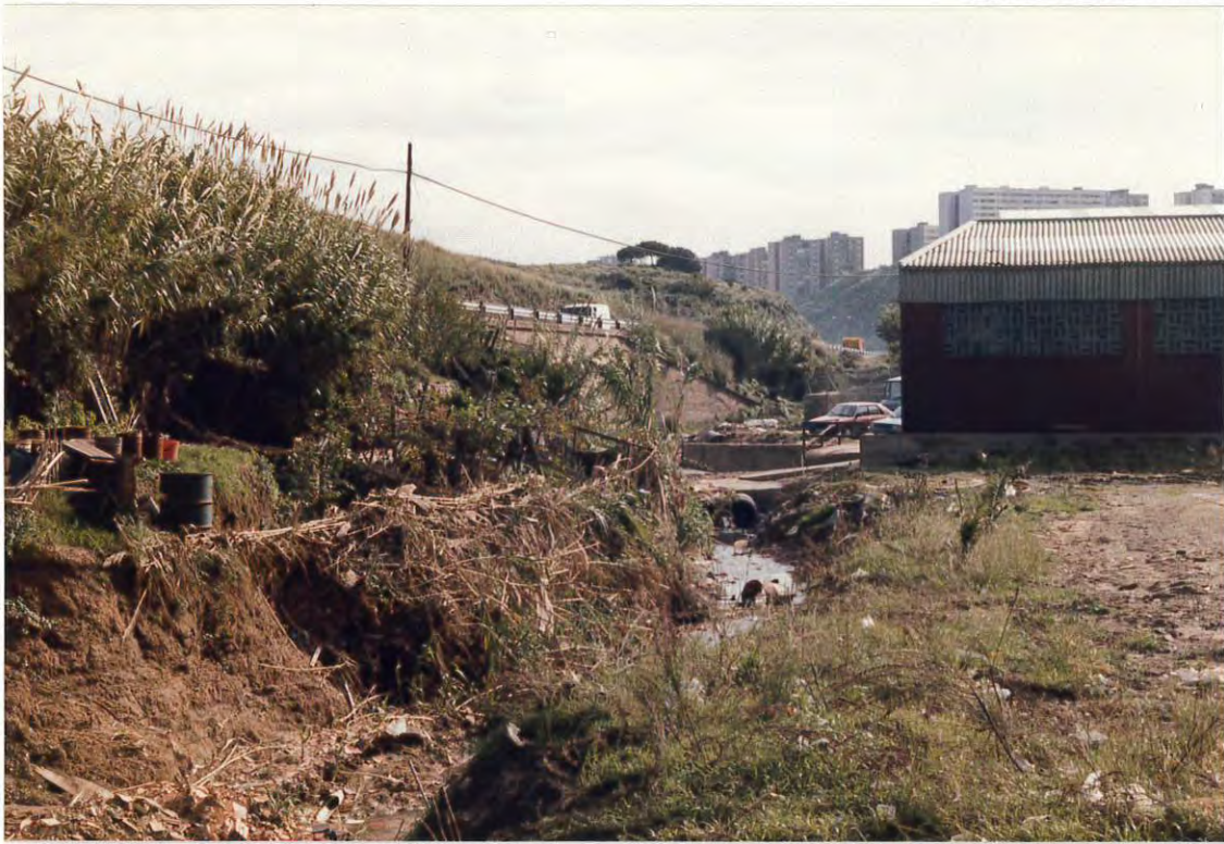
Figura 3. Los colectores del Torrent Tapioles alternan con tramos de canales de tierra, cuyo estado es claramente deplorable.
