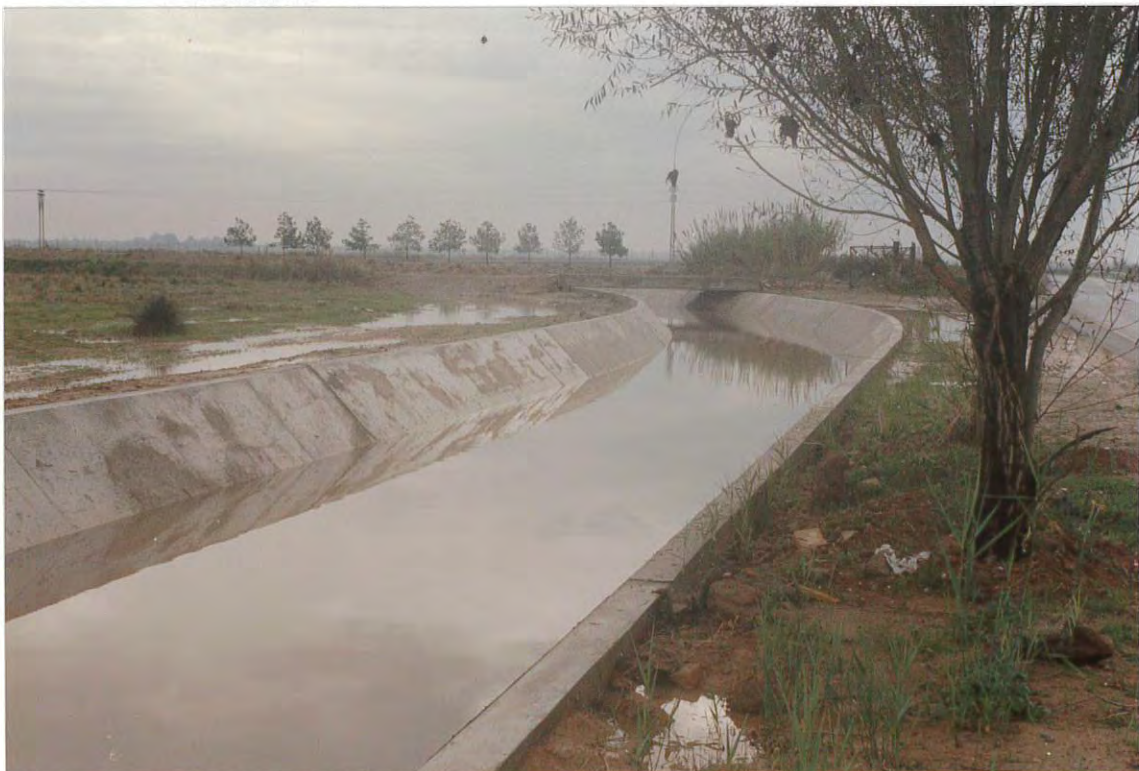
Figura 4. Vista aguas abajo del tramo en construcción del canal de la Aviación, unos días después del episodio de intensas lluvias.
