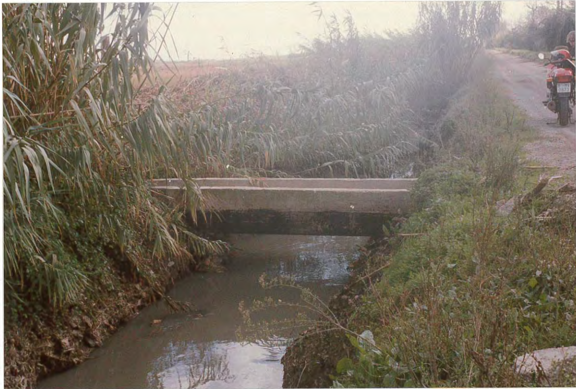
Figura 7. Nivel máximo alcanzado por las aguas en el canal de la Bunyola, cuyo desagüe al mar está protegido por un dique de escollera.
