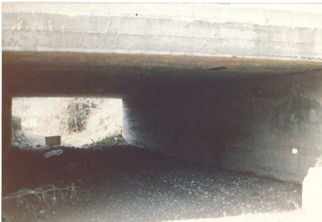
Figura 4. La riera de les Argiles a su paso bajo la carretera de acceso al polígono industrial. La capacidad de la sección es insuficiente para desaguar los caudales de la riera.
