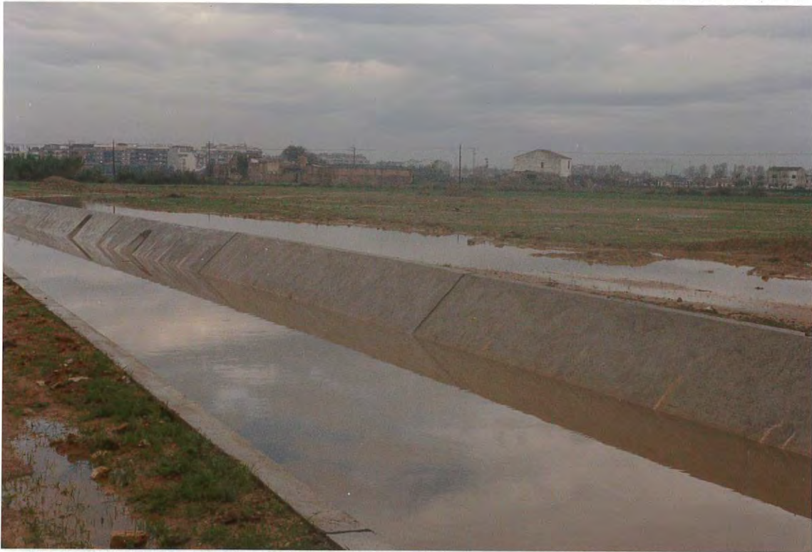
Figura 3. Vista aguas arriba del tramo en construcción del canal de la Aviación, unos días después del episodio de intensas lluvias.
