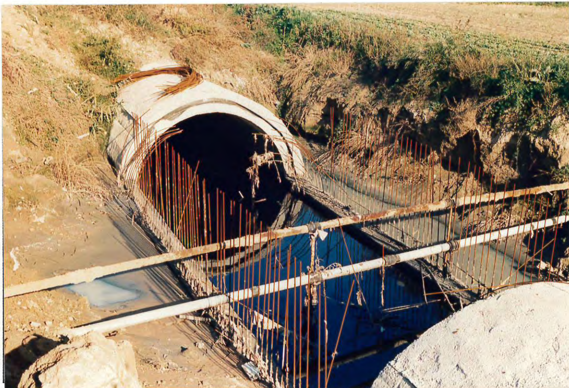
Figura 3. Cruce del colector del Rec de Farré i Mora con servicios afectados de gas, lo que ha causado la paralización de las obras.
