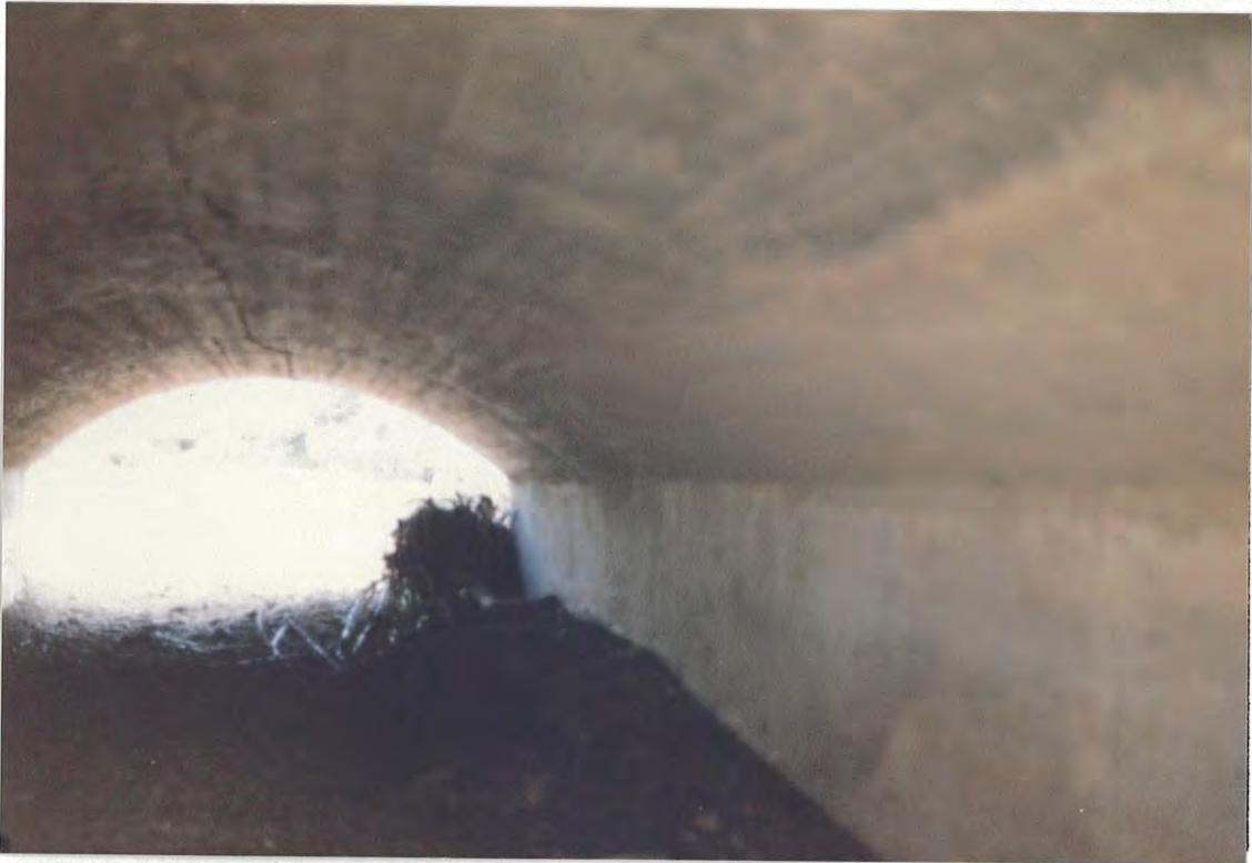
Figura 1. El Torrent Batsacs a su paso bajo la carretera N-II, donde pueden observarse la grieta existente en la clave, y la gran cantidad de arrastres acumulados.
