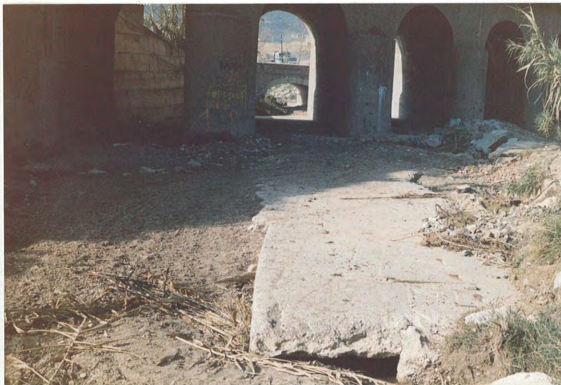
Figura 1. Destrozos existentes en la losa de la solera, por donde el agua escapa antes de cruzar el puente del ferrocarril.
