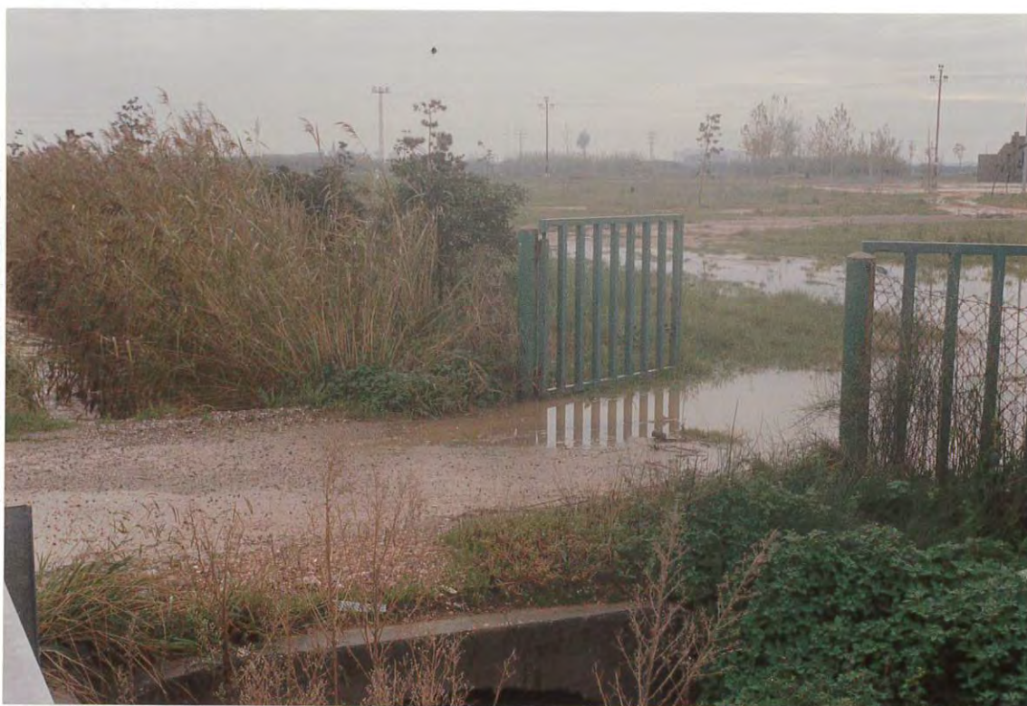
Figura 2. Inundaciones producidas al inicio del canal de la Aviación.
