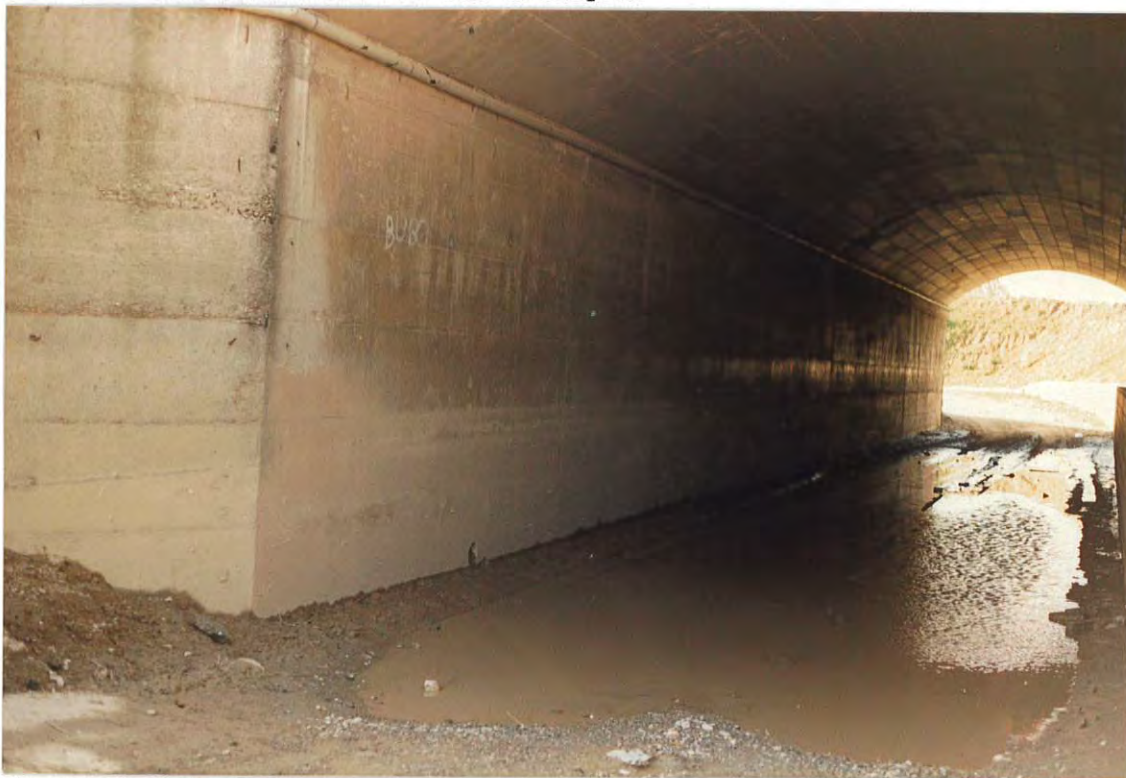
Figura 6. Las aguas alcanzaron 1 m de altura, lo que obligó a su achique mediante bombas, con objeto de poder restablecer la circulación de vehículos.
