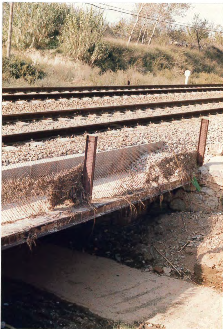
Figura 3. El Torrent Batsacs aguas arriba de su paso bajo el puente de RENFE. El agua sobrepasó las vías férreas, a pesar del buen estado de limpieza del cauce.
