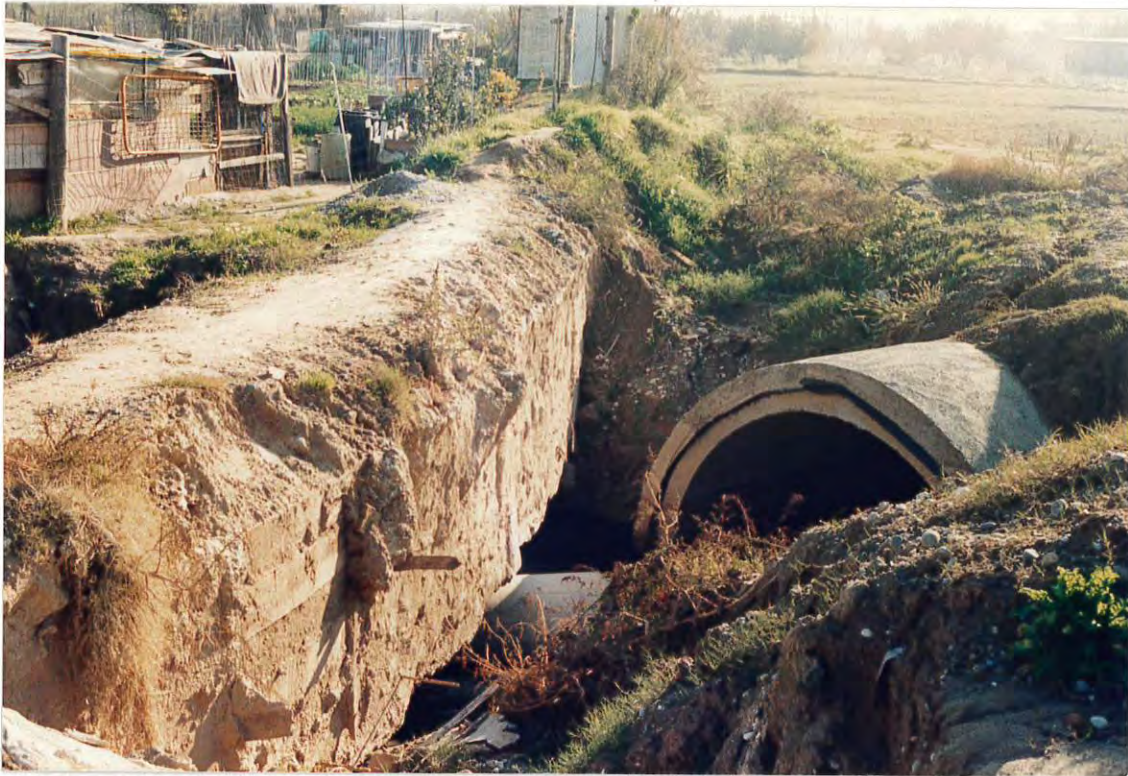
Figura 1. Cruce del colector del Rec Farré i Mora con el Canal de la Infanta. Unas previsiones inadecuadas han impedido la finalización del colector.
