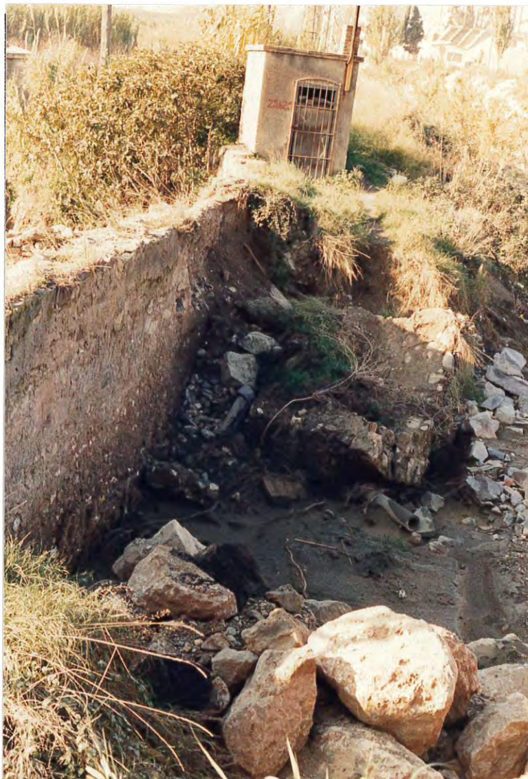
Figura 6. Muro de contención izquierdo totalmente descarnado, con desaparición del camino existente. La destrucción de este muro de hormigón propiciaría la inundación de todo el casco urbano de Molins de Rei.
