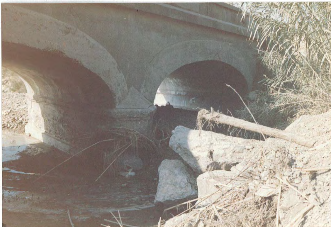
Figura 4. Margen derecha del puente de la carretera de Caldes de Montbui a Molins de Rei. El vano derecho está taponado completamente, y el contiguo parcialmente obstruido.
