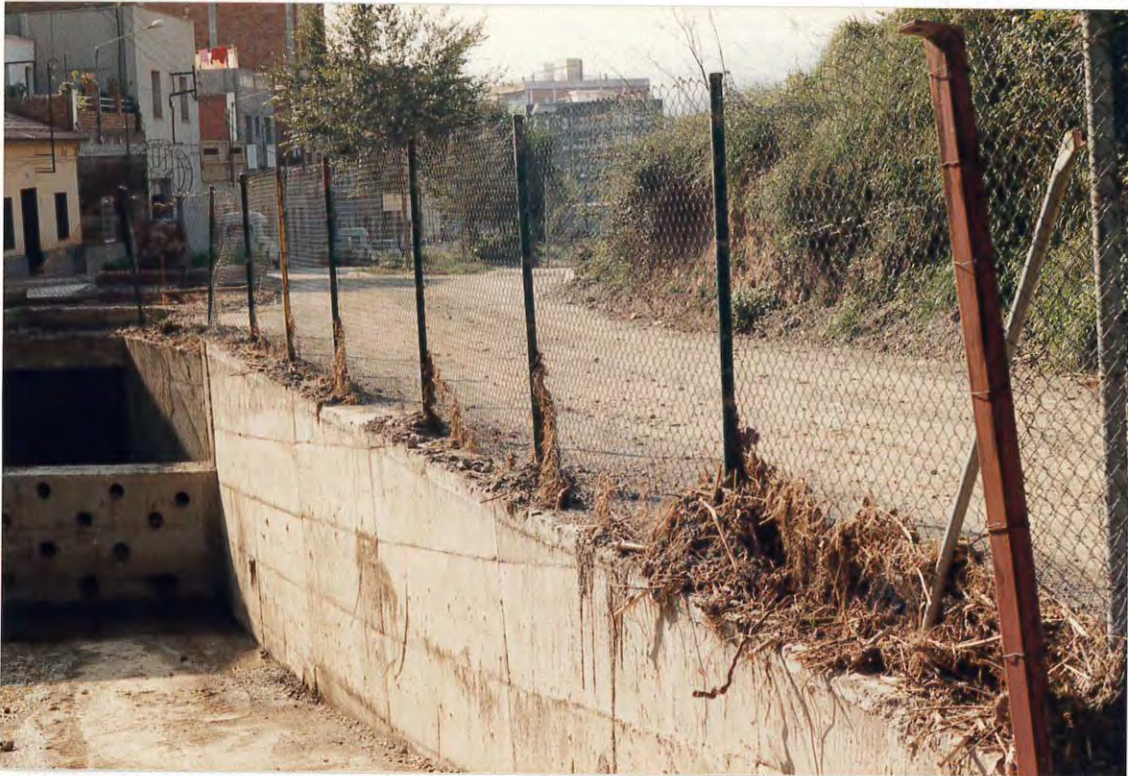
Figura 1. Nivel alcanzado por las aguas, aguas arriba del inicio del colector. Obsérvese la posición del dispositivo de retención de arrastres.
