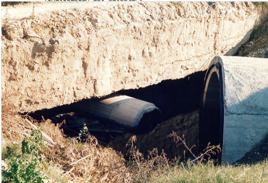
Figura 2. Detalle del estado actual del cruce del colector del Rec Farré i Mora con el Canal de la Infanta.
