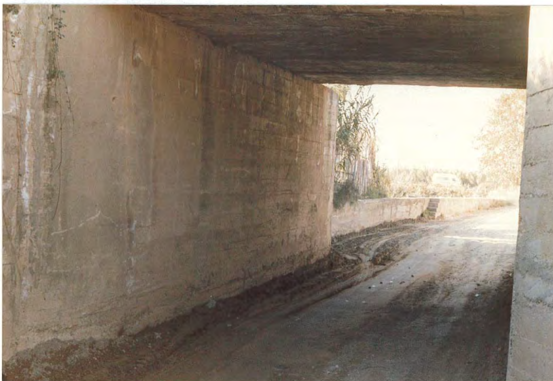
Figura 2. Cauce de la riera Can Paissa a su paso bajo el puente del ferrocarril, aguas arriba de la carretera N-II. El nivel de las aguas superó 1 m de altura.
