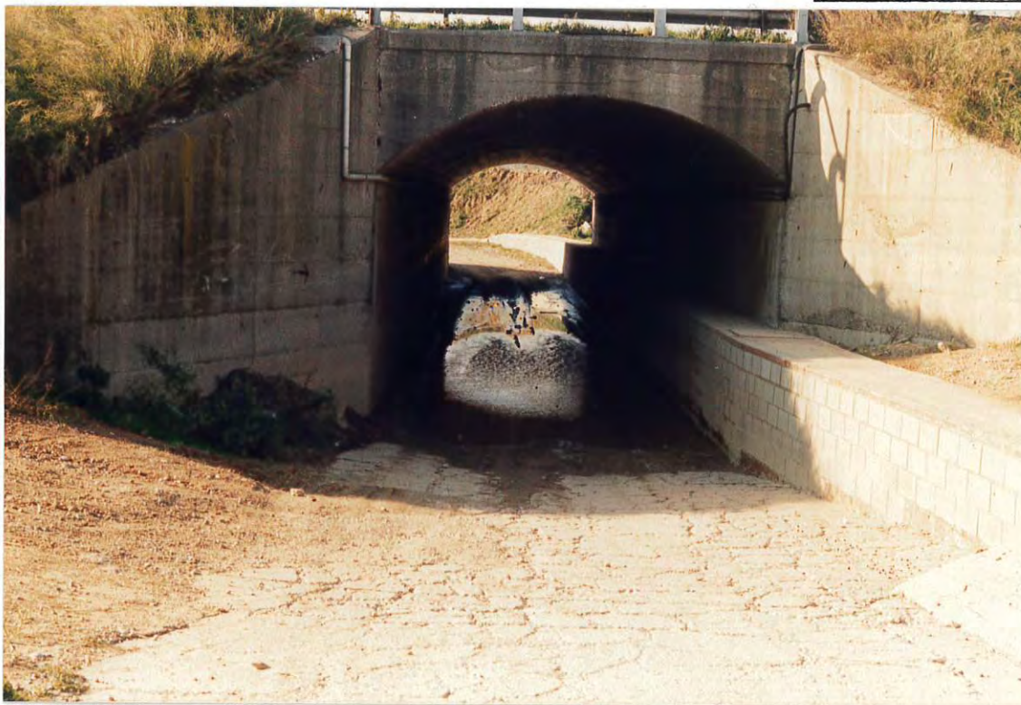
Figura 5. Túnel bajo la autopista A-2. El paso de camiones de la obra del colector ha agrietado el pavimento, propiciando la obturación de los drenajes.
