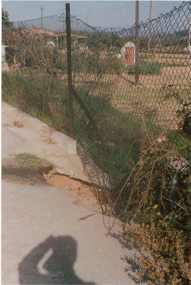
Figura 2. Destrozos producidos por las aguas de escorrentía en el firme de una calle, en el punto de desagüe del colector que constituye el tramo urbano de la riera Boter.
