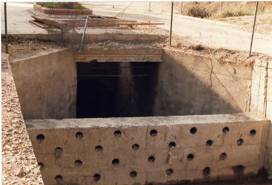
Figura 2. Vista del dispositivo de retención de arrastres, en la que se aprecia la mayor parte de los orificios obturados.
