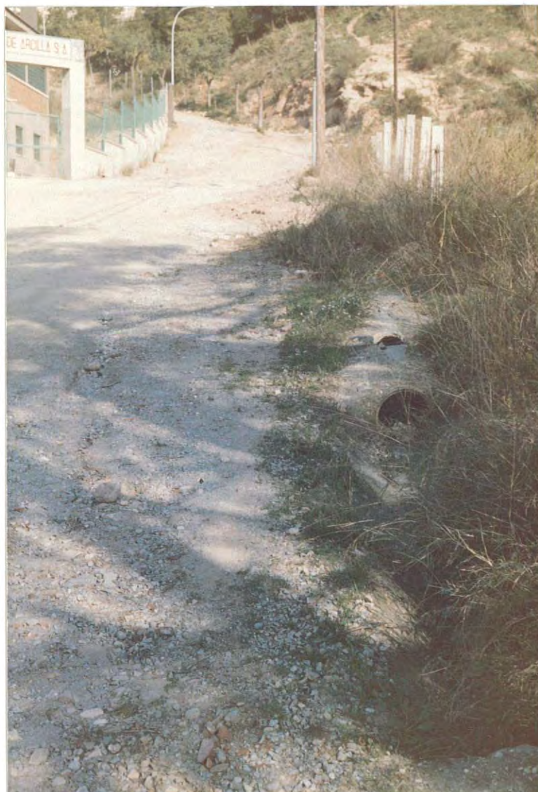
Figura 1. Estado del alcantarillado de la calle Brasil, tras las lluvias del octubre de 1987.
