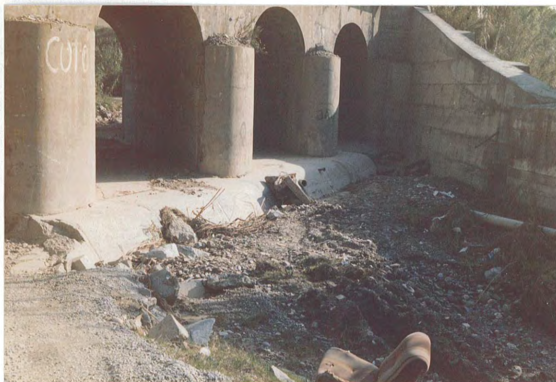
Figura 2. Escombros, desperdicios y arrastres acumulados aguas abajo del puente del ferrocarril.
