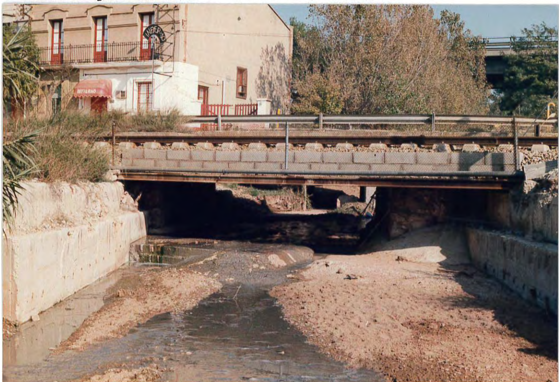
Figura 2. El Torrent Batsacs a su paso bajo el puente de RENFE. El buen estado de limpieza del cauce evitó que los daños causados por las aguas fueran mayores.
