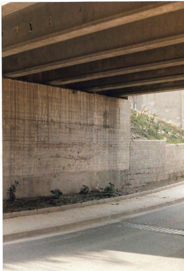
Figura 1. Cruce de la calle Joaquím Castellví bajo la carretera de Barcelona a Ribas, antes de su cruce con el río Ripoll. Las aguas alcanzaron 2,4 m de altura.
