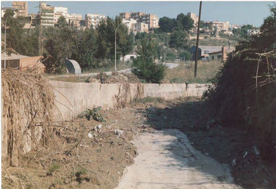
Figura 5. Tramo encauzado de la riera de les Argiles, en el que se aprecia una gran cantidad de arrastres y vegetación.
