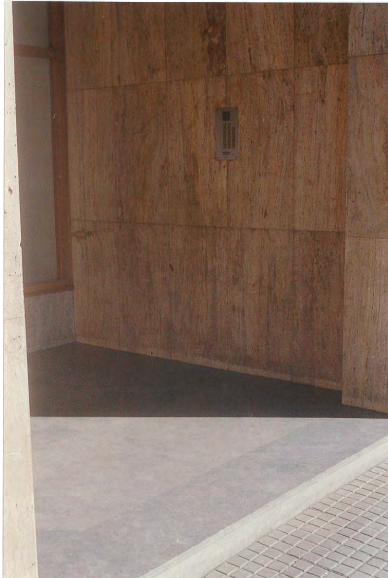
Figura 1. Entrada de una de las viviendas de la calle Balmes, donde el agua alcanzó una altura máxima de 5 cm.
