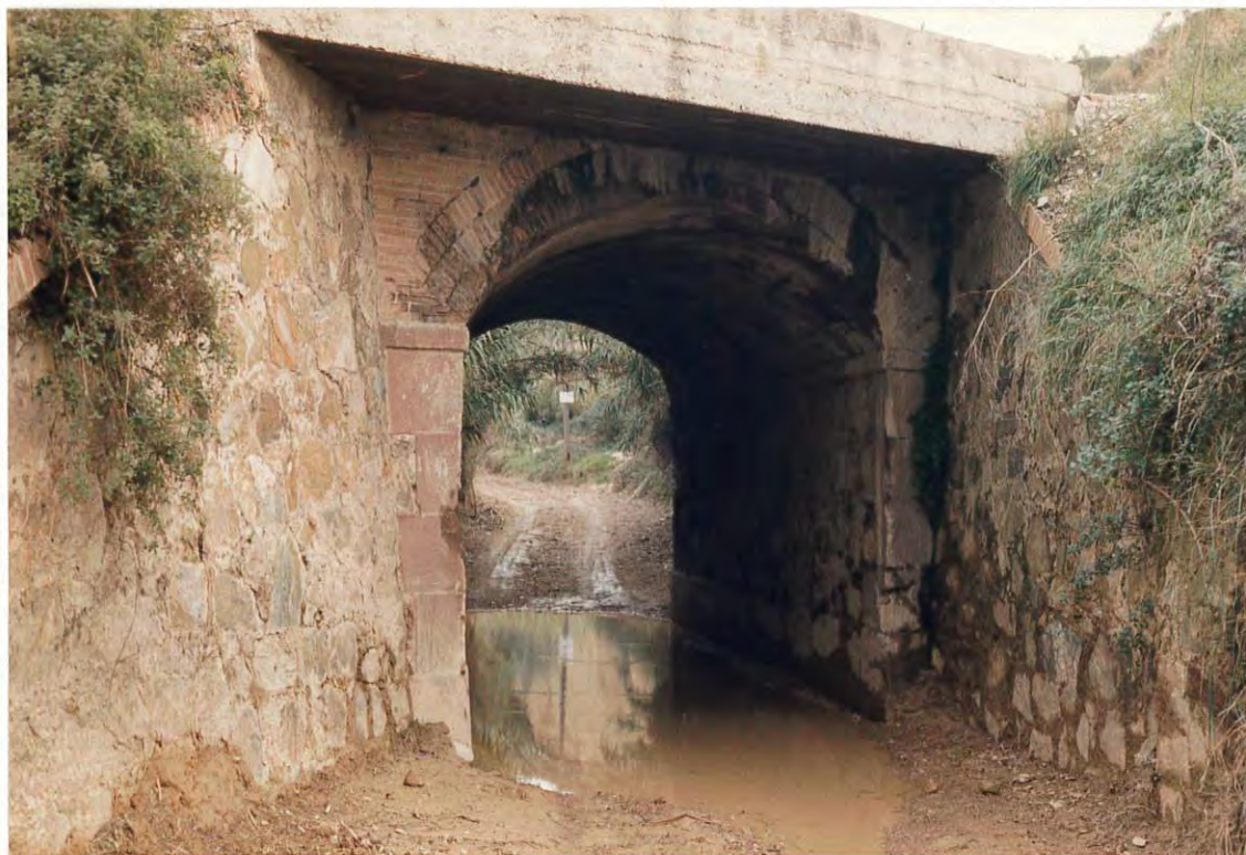
Figura 1. Cruce de la riera Can Sant Tomàs bajo el puente del ferrocarril, donde las aguas alcanzaron 50 cm de altura.
