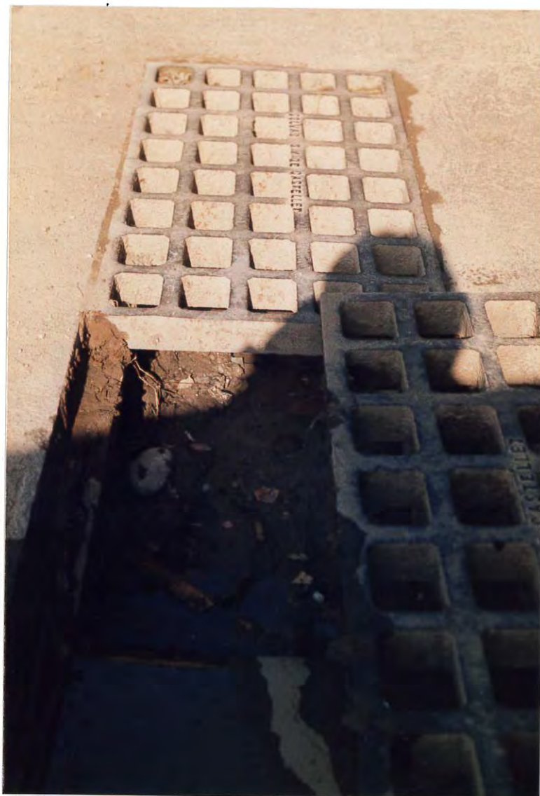
Figura 2. Reja de drenaje de la calle Peu de la Creu, en la que se observa el aterramiento total en que se encontraba.
