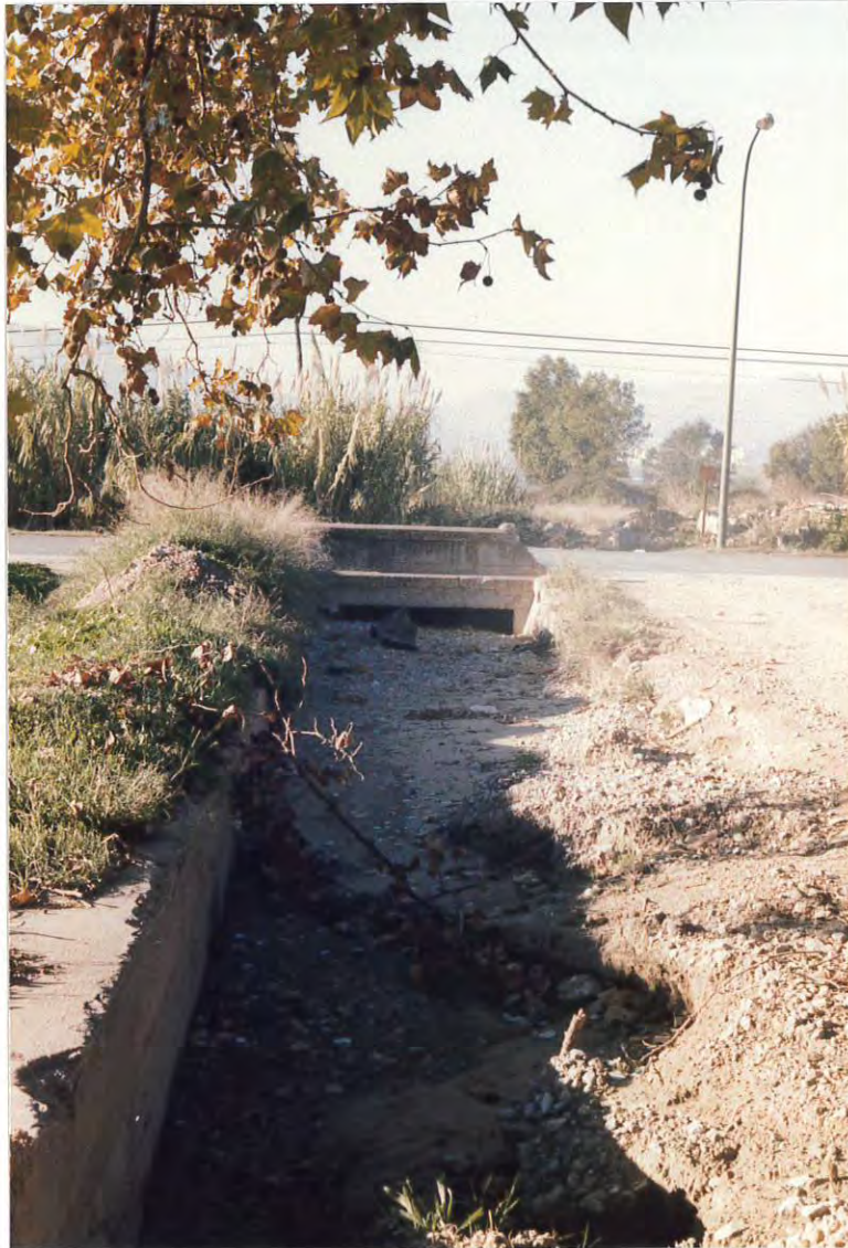
Figura 3. Vista general del cauce de la riera Can Paissa, aguas arriba de su cruce con la carretera N-II. Los progresivos aterramientos han eliminado prácticamente su cauce natural.
