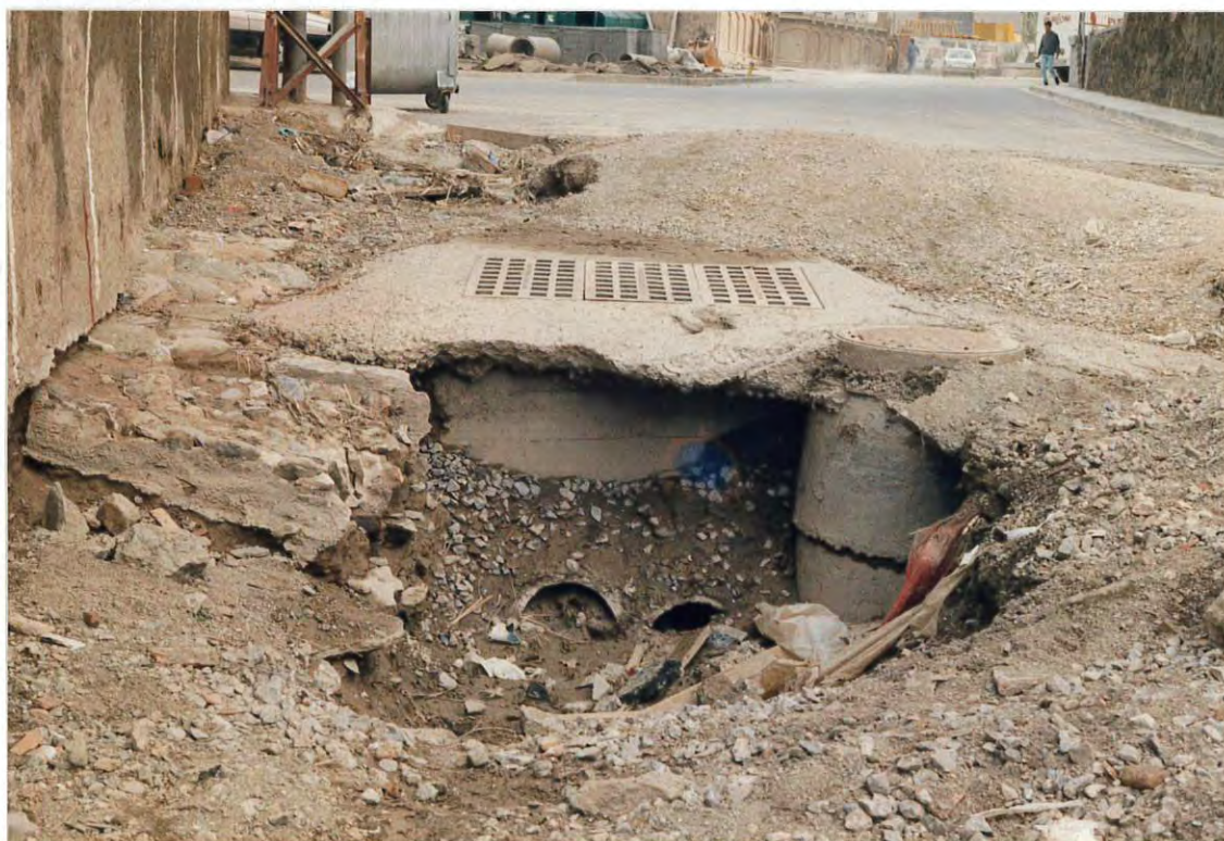
Figura 4. Estado en el que quedó el desagüe existente en el cruce de la calle Sagriment con la riera de la Salut.
