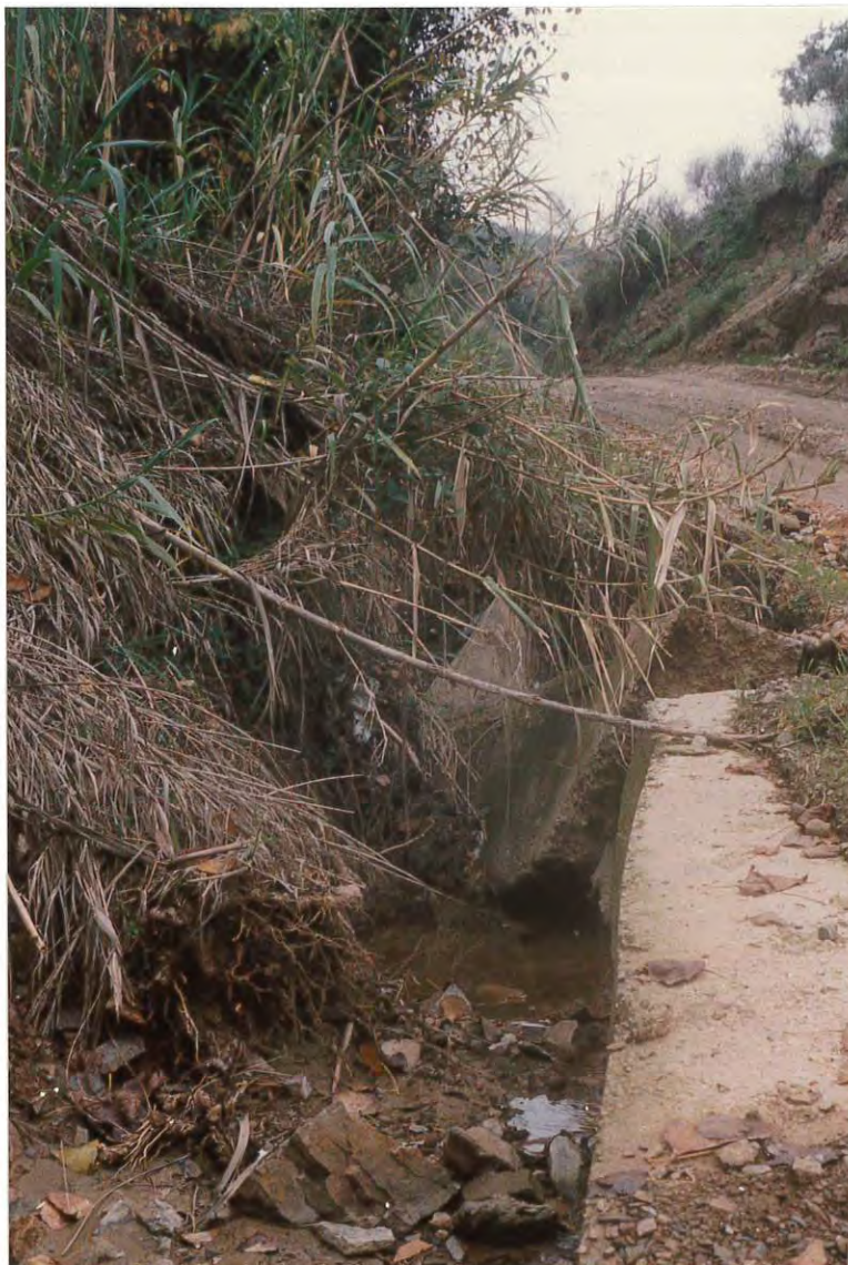
Figura 3. Estado del cauce de la riera, en las inmediaciones del camino de la Font.
