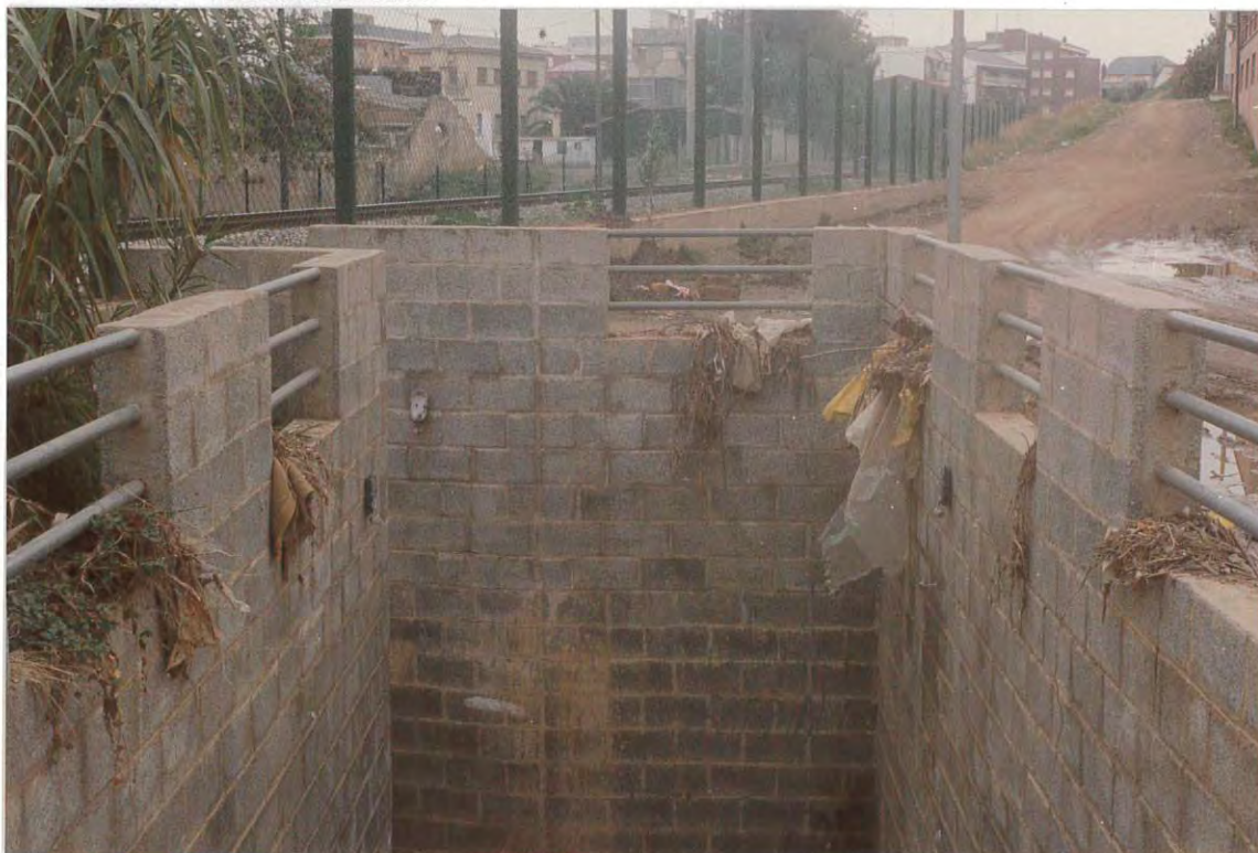
Figura 2. Arrastres retenidos en las barandillas de protección del paso peatonal bajo la línea de los ferrocarriles de la Generalitat.
