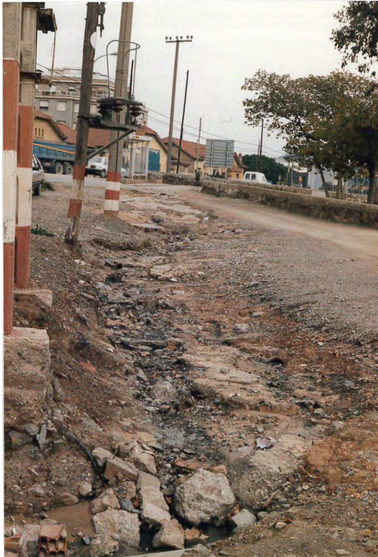
Figura 6. Destrozos producidos en una calle lateral a la riera de Sant Just. Ante la ausencia de imbornales, el agua se incorporó a la riera por un orificio provisional existente en el hastial.
