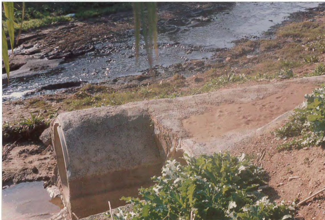
Figura 2. Los sedimentos acumulados sobre los conductos de vertido muestran que las aguas sobrepasaron ese nivel.
