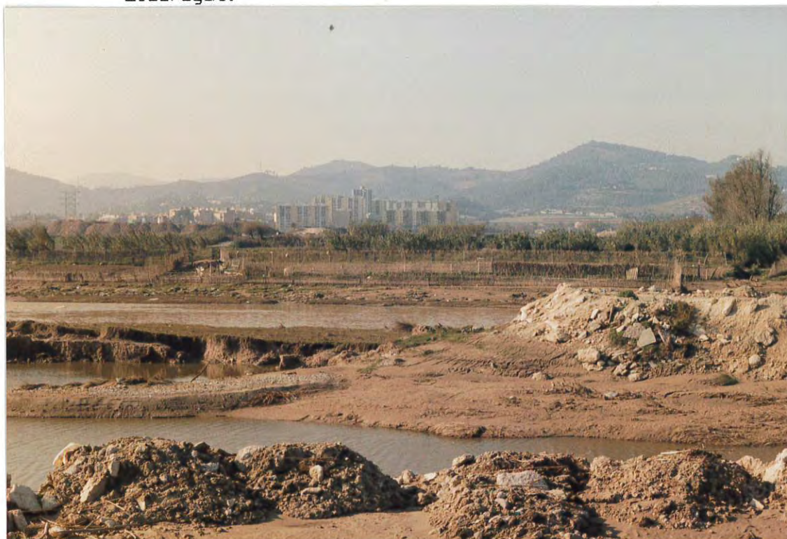
Figura 2. Deterioros producidos por las aguas en el terraplén de protección del colector de Sant Joan Despí.
