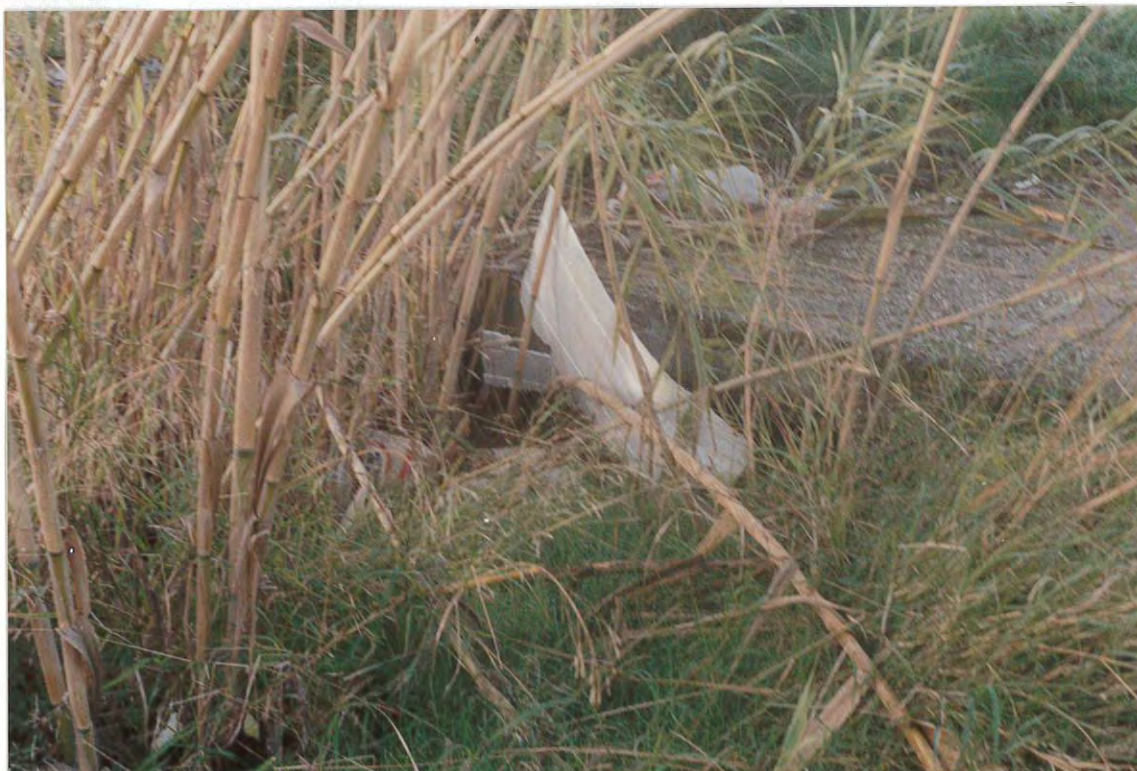
Figura 2. Desarrollo alcanzado por la maleza existente en el cauce de la riera del Manyá, inmediatamente aguas abajo de su cruce bajo la carretera N-II.
