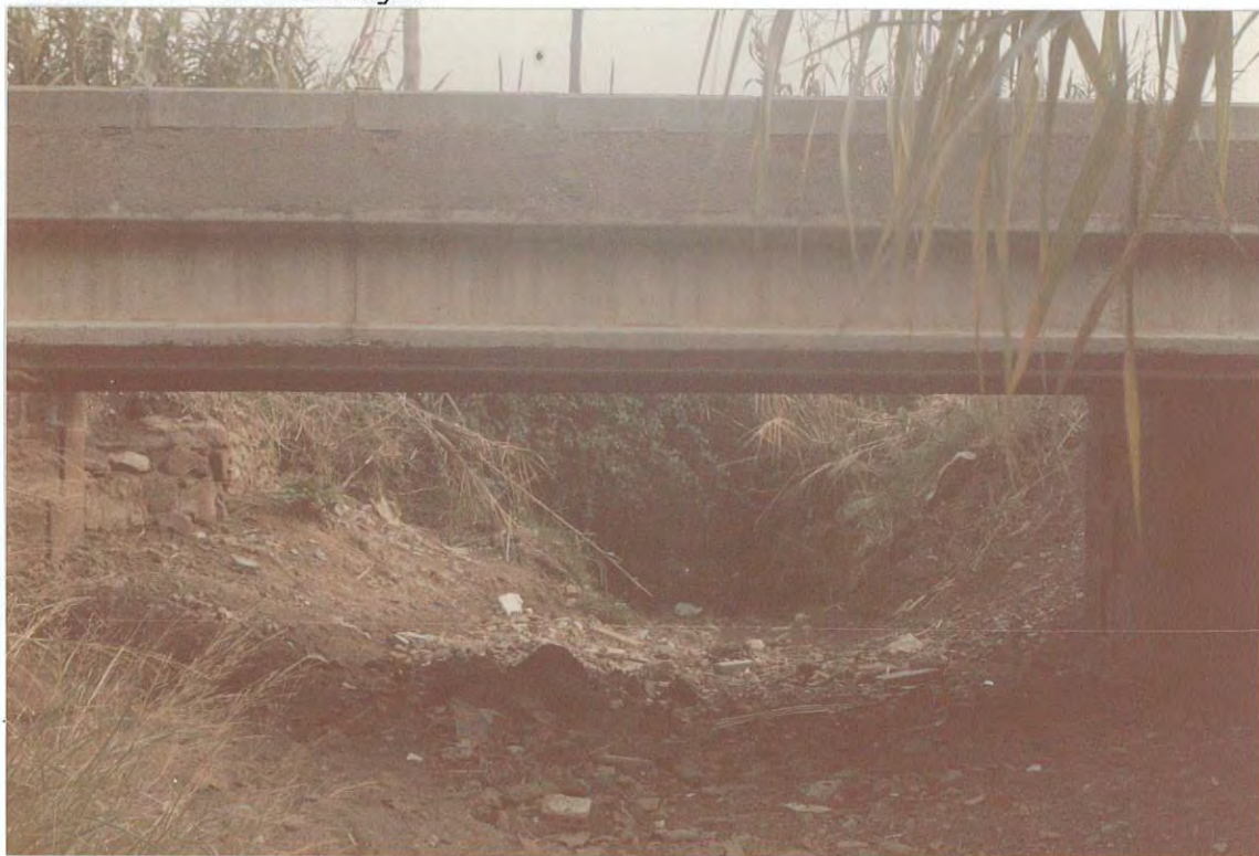
Figura 2. Cauce de la riera de Can Solé, a su paso bajo el puente de la línea férrea de Barcelona-Martorell.
