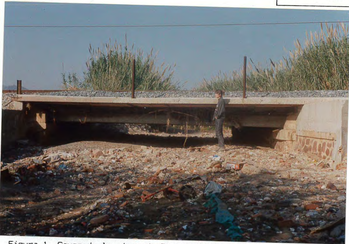
Figura 1. Cauce de la riera de Sant Climent, a su paso bajo la línea férrea Barcelona-Zaragoza. La altura libre permitía, en el pasado, la circulación de carruajes agrícolas.
