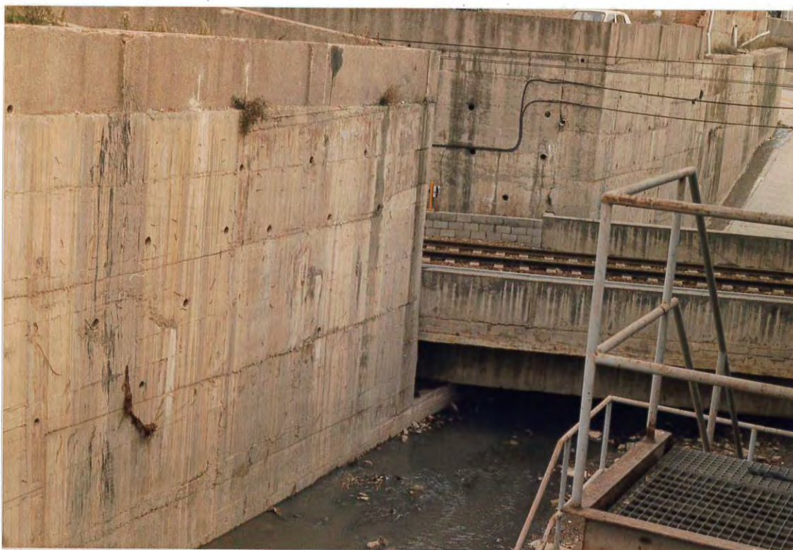
Figura 3. Detalle de uno de los hastiales de la riera de Sant Just. Los materiales colgando de los latiguillos del hormigón muestran el nivel alcanzado por las aguas.
