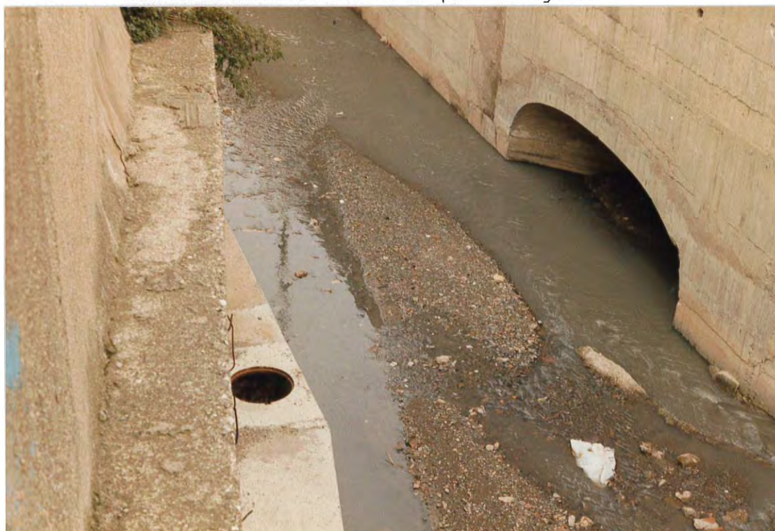
Figura 4. Entronque de un colector con la riera de Sant Just, aguas abajo del cruce con la vía del ferrocarril. Se aprecian arrastres y el taponamiento del pozo de registro.
