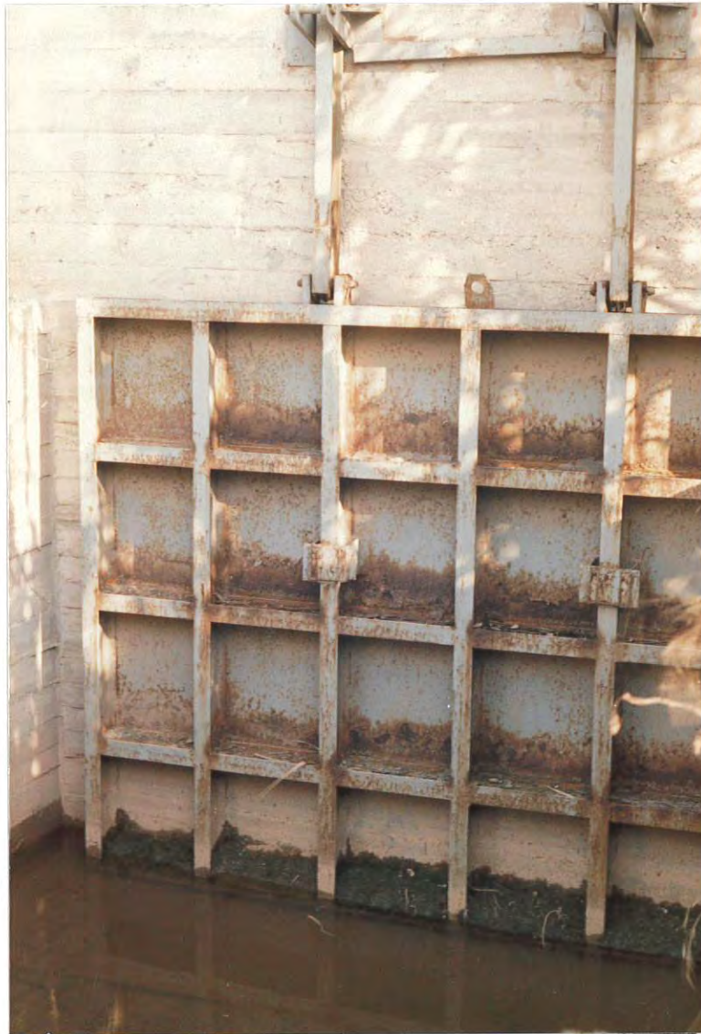
Figura 2. Compuerta metálica para proteger el casco urbano de Sant Joan Despí frente a los posibles desbordamientos del río Llobregat.
