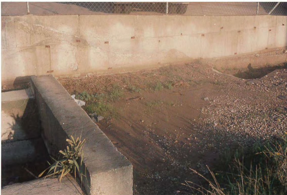
Figura 1. Arrastres acumulados en el cauce de la riera del Manyá, aguas arriba de su cruce bajo la carretera N-II.
