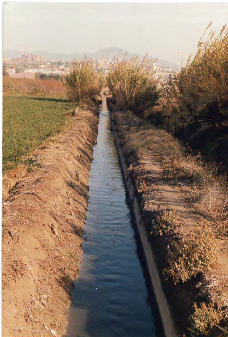
Figura 1: Tramo final de la riera d'en Nofre, parcialmente obstruido y con su lecho más elevado que los campos colindantes.
