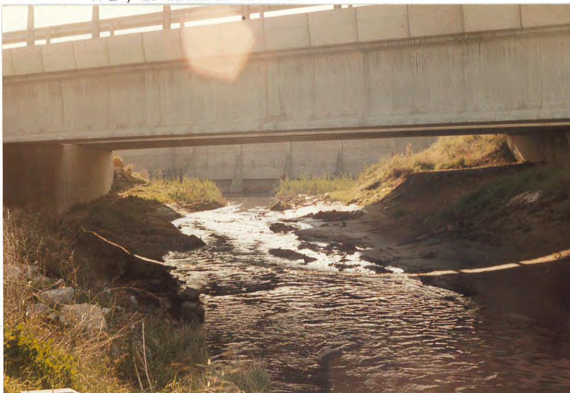
Figura 2. El canal de desagüe de la margen izquierda del río Llobregat a su paso bajo el Cinturón Litoral. Al fondo, recrecimiento con tochanas del aliviadero al río.
