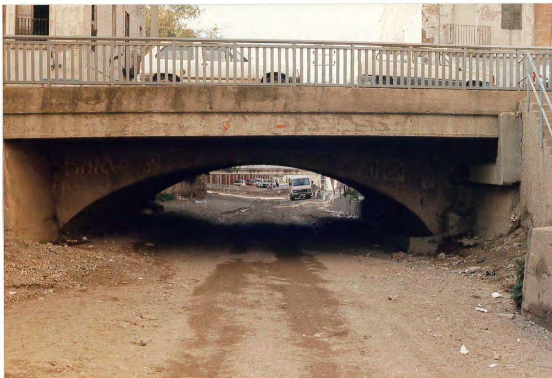
Figura 5. Cruce de la riera bajo la carretera N-II. Las aguas alcanzaron la clave del arco, situado a 1,9 m sobre el lecho de la riera.
