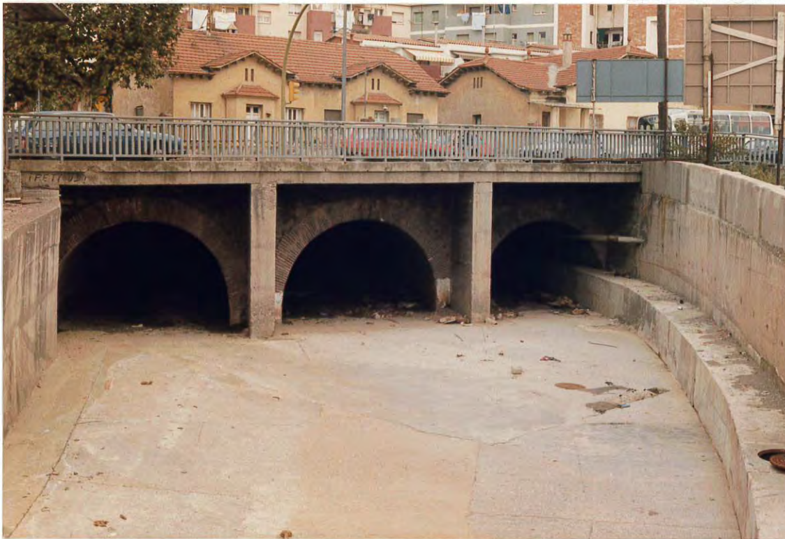
Figura 1. Cauce de la riera de Sant Just a su paso bajo la carretera N-II, donde pueden apreciarse los arrastres acumulados, y la presencia de una tapa de alcantarillado.
