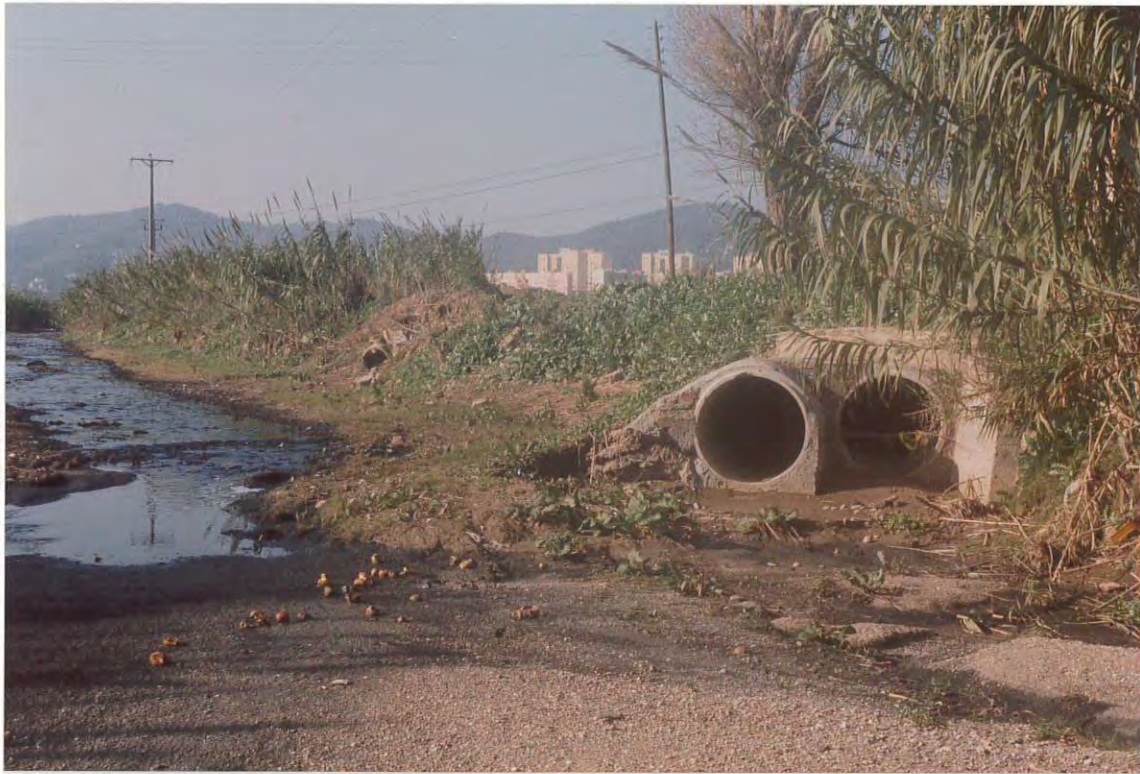
Figura 1. Cauce de la riera de Torrellas, en su entronque con los conductos de vertido de las aguas de retorno de riego.
