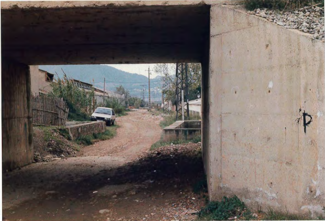
Figura 1. Cruce de la riera bajo el puente del ferrocarril, donde el agua alcanzó 1 m de altura.
