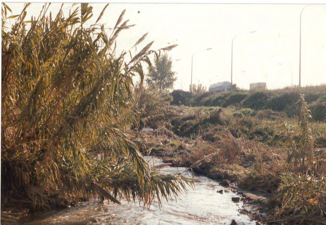
Figura 9. Canal de desagüe paralelo a la autopista A-2, aguas abajo de la desembocadura de la riera de la Salut. Obsérvese la reducción de sección causada por los arrastres.
