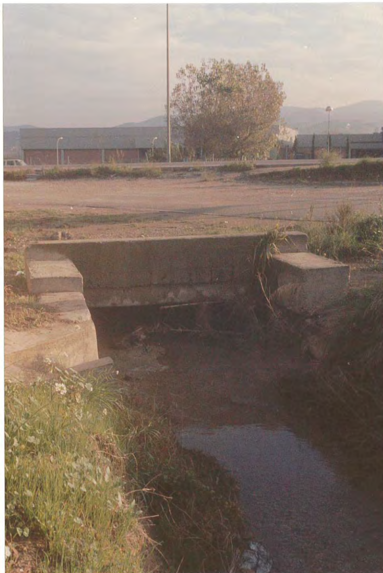
Figura 4. Estado actual de la sección en cajón por la que la riera del Manya cruza la carretera N-II.
