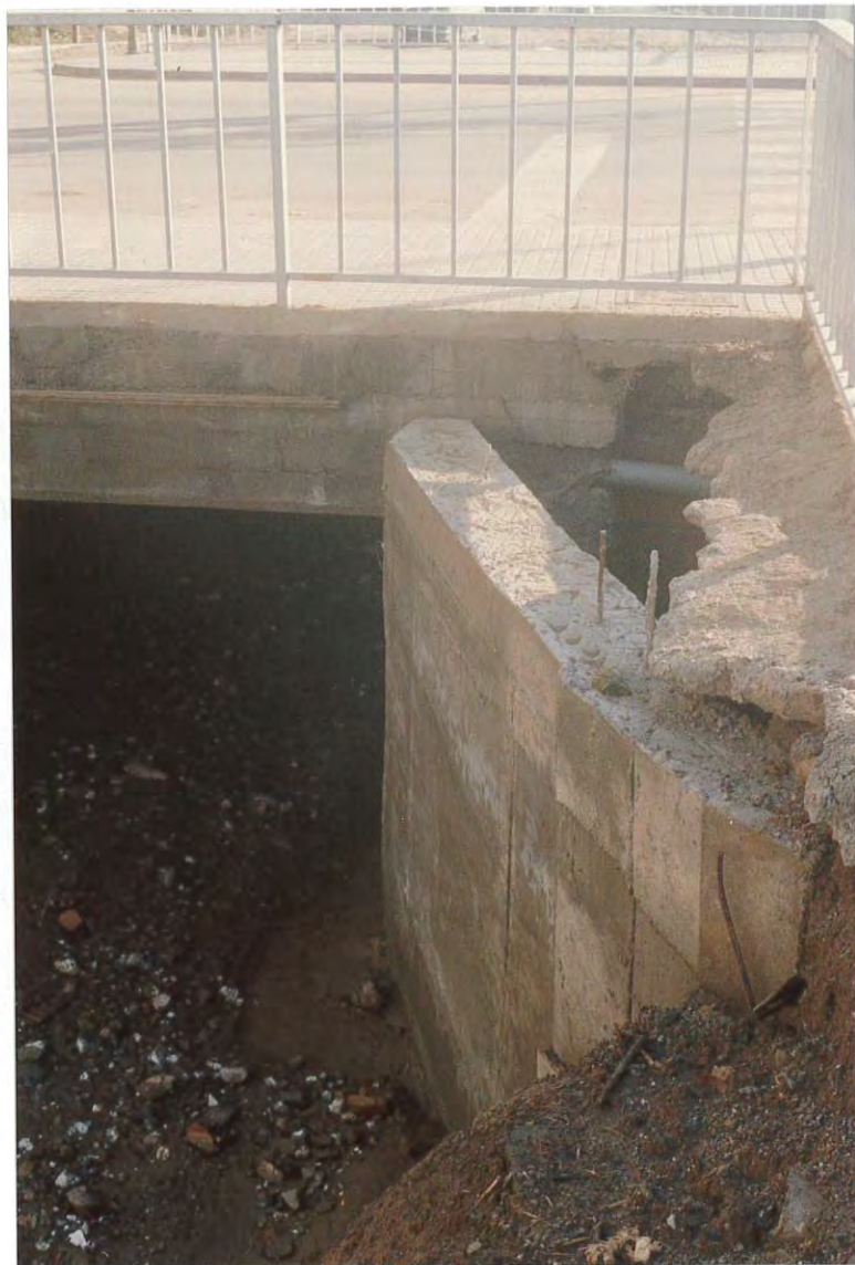
Figura 2. Desperfectos causados por las aguas en uno de los puentes que cruzan la riera de Sant Cugat. El nivel de las aguas llegó hasta la mitad de la barandilla de protección del puente.
