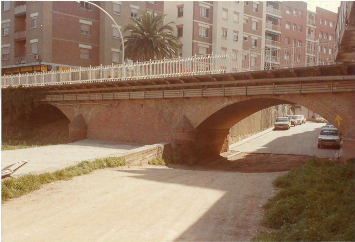
Figura 1. Vista general del puente de la carretera de la Rabassada, así como del colector y de la zona inundada.
