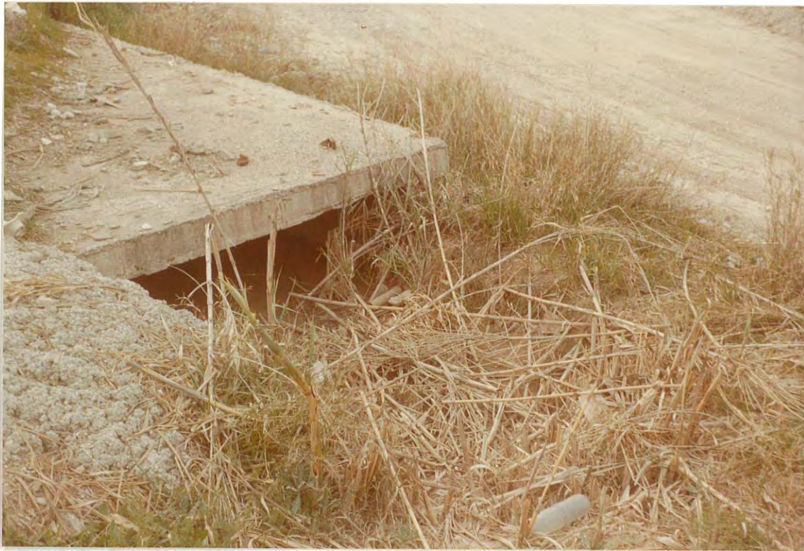
Figura 1. Estado del cauce de la riera a la salida del cruce con la carretera nacional N-II.
