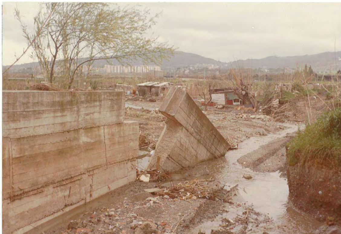
Figura 1. Efectos de las aguas en el muro de encauzamiento.
