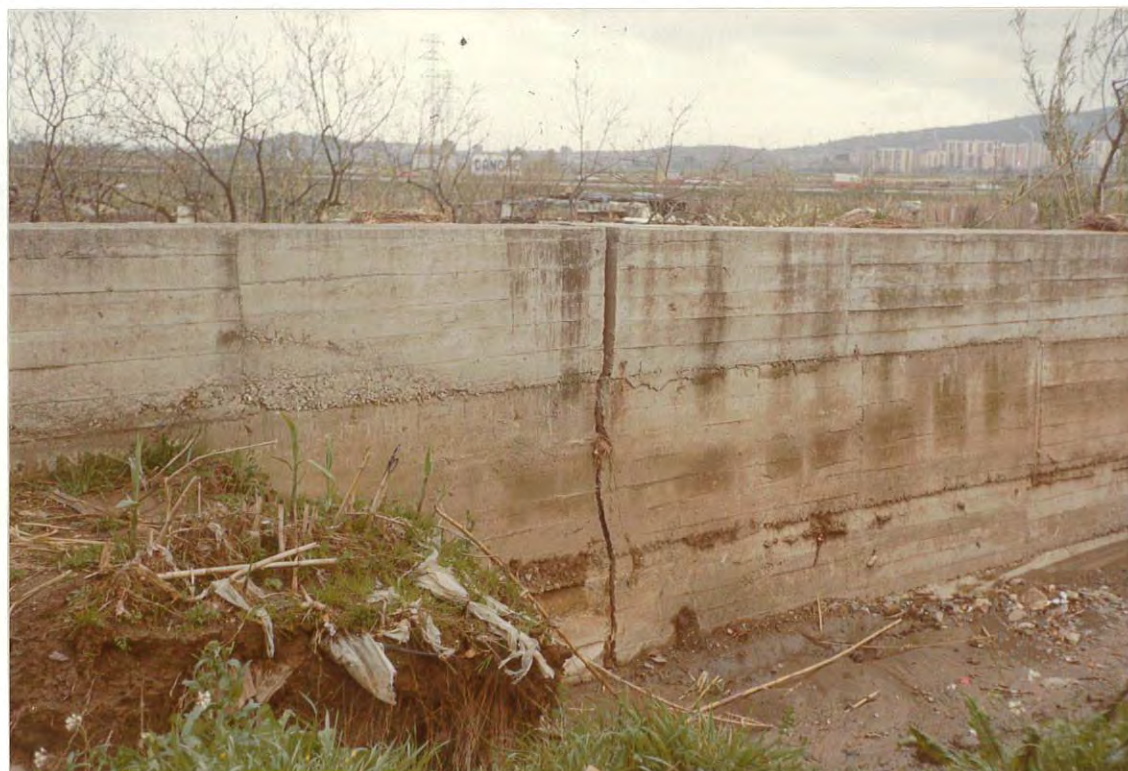
Figura 2. Estado actual del muro de encauzamiento, y acumulación de residuos en el cauce de la riera.
