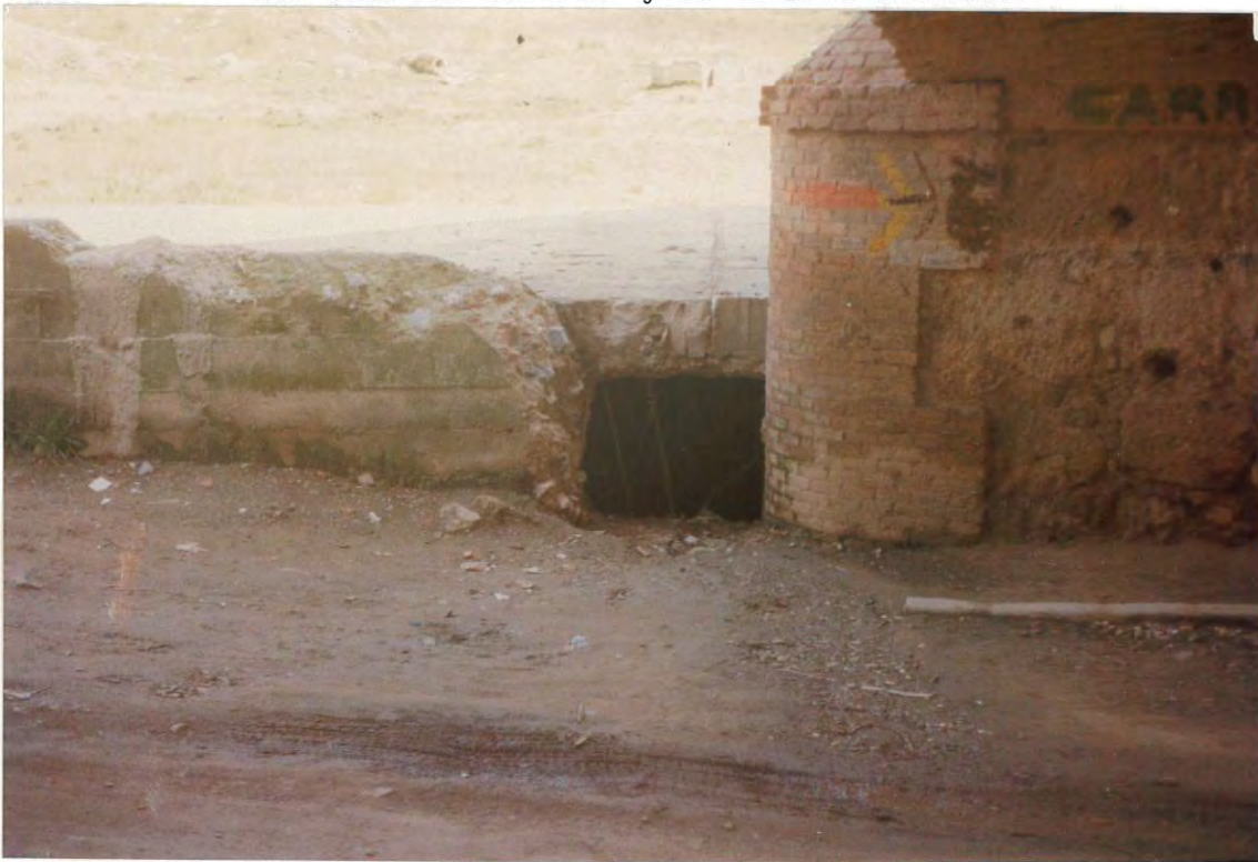
Figura 2. Detalle del boquete practicado en el colector para desaguar la zona inundada.
