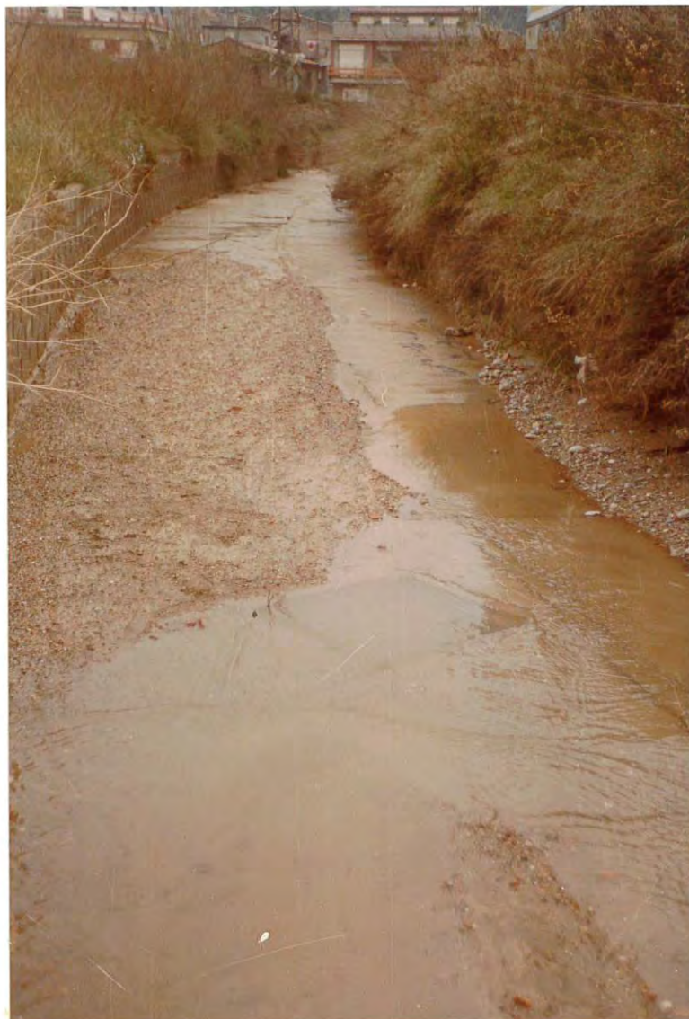
Figura 3. Tramo encauzado de la riera de Les Argilas. Vertido de aguas residuales de una industria colindante.
