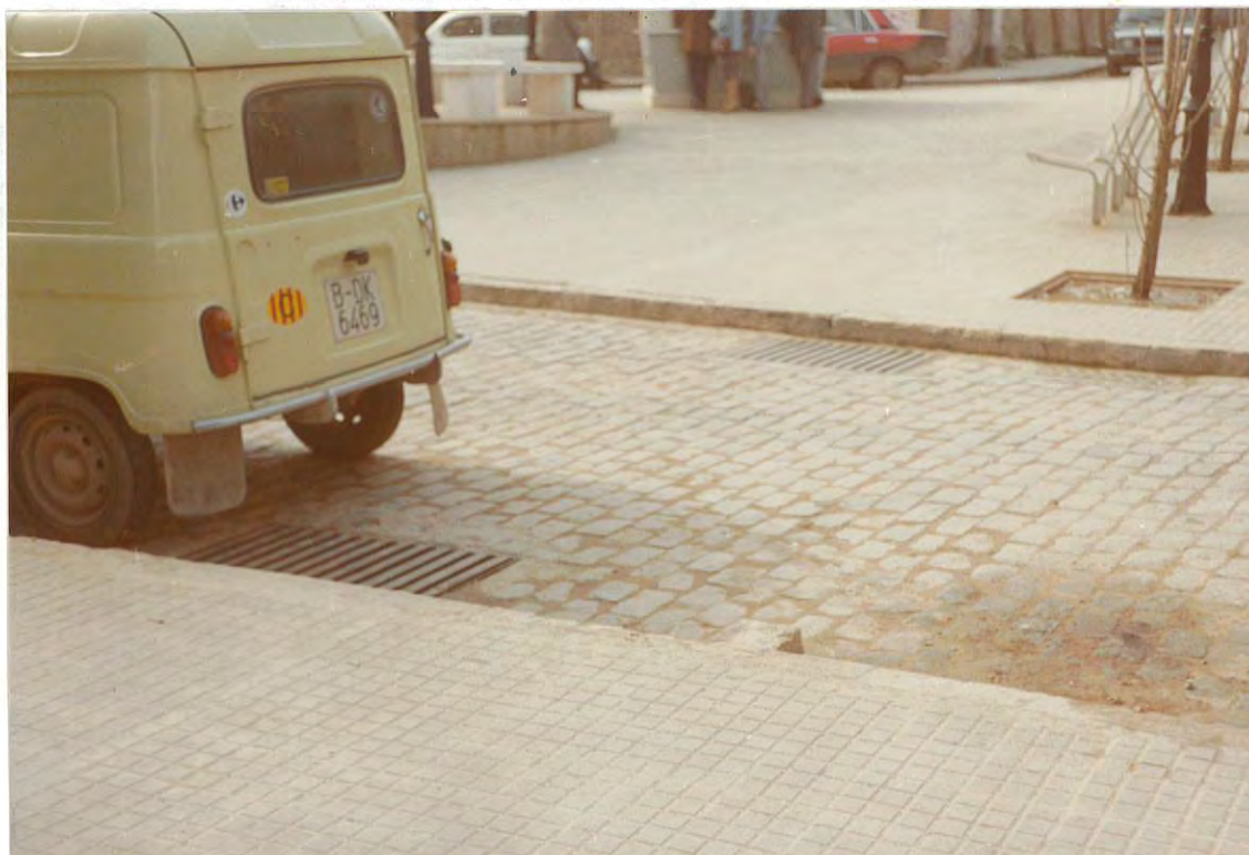
Figura 2. Detalle de las dos rejillas construidas recientemente con capacidad insuficiente ante fuertes precipitaciones.
