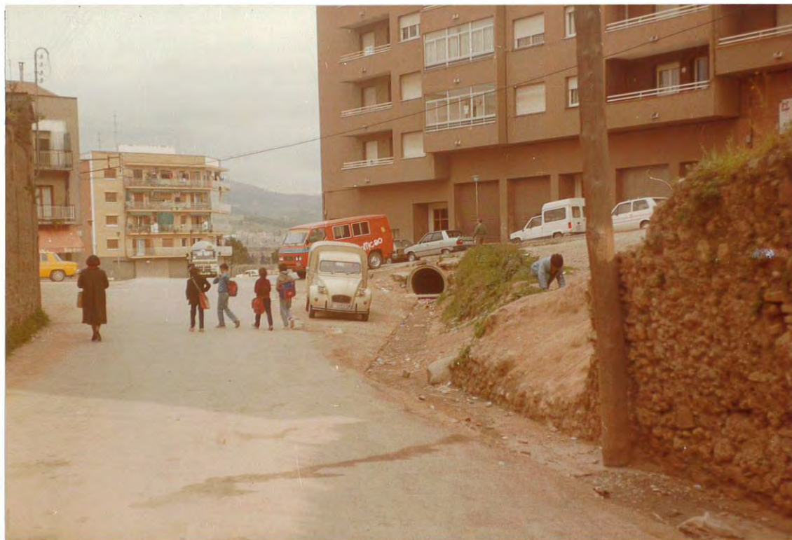
Figura 1. Conducción de desagüe con cota superior a la del cauce de la riera bajo el puente.
