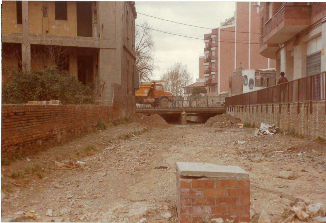
Figura 1. Calado actual de la riera a su paso por la carretera de Sant Vicenç dels Horts a Sant Boi de Llobregat.
