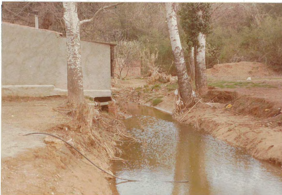
Figura 2. Detalle de la erosión provocada por la riera.
