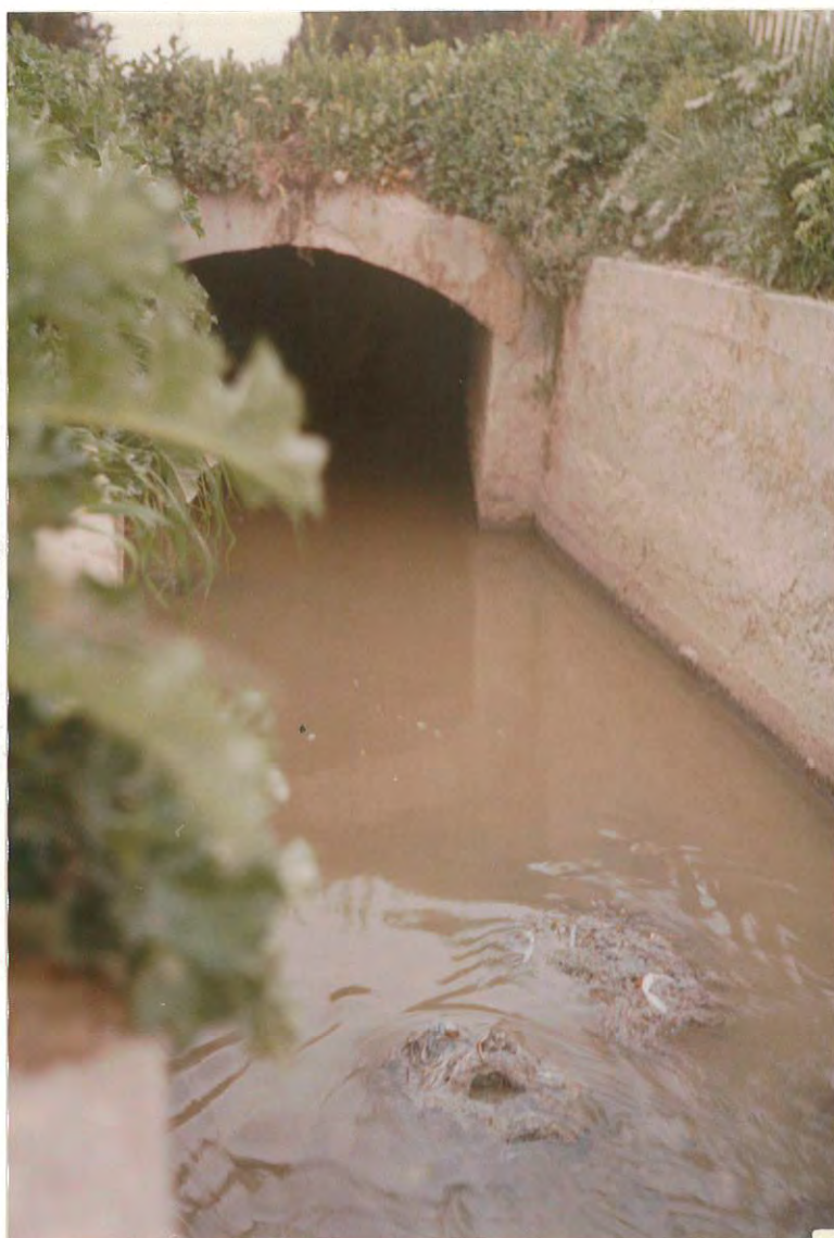
Figura 2. Capacidad actual del colector de la Bunyola.
