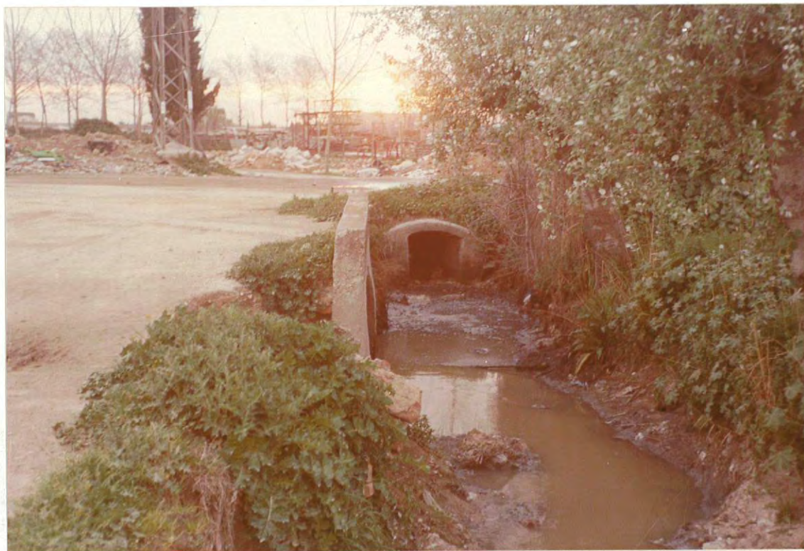
Figura 3. Unión del colector de la Marina con el colector de la Bunyola.
