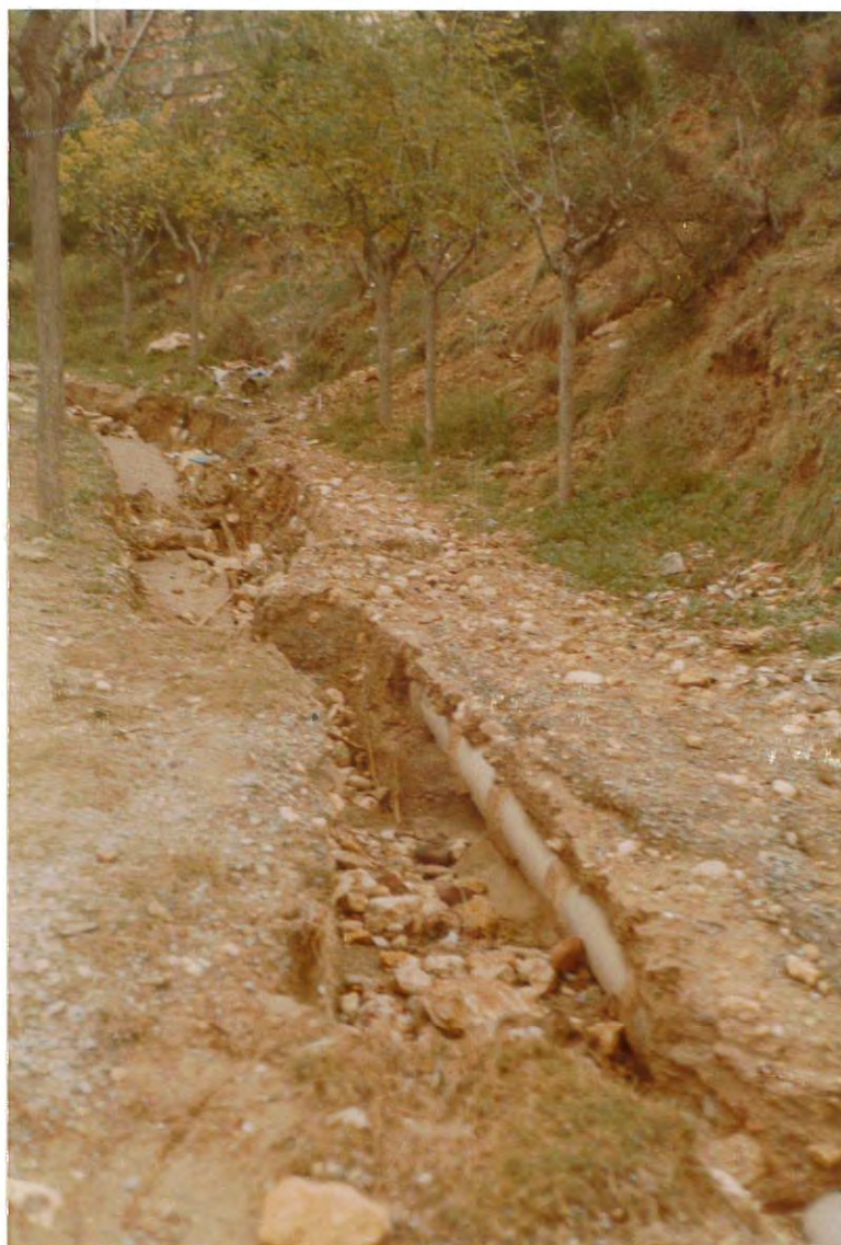
Figura 2. Estado en que quedó la calle Brasil.
