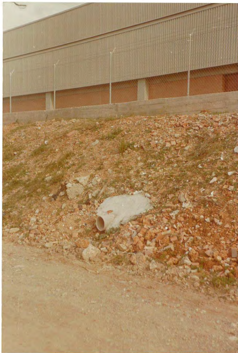
Figura 3. Desagüe de aguas pluviales de la empresa PRINTER sobre el camino .
