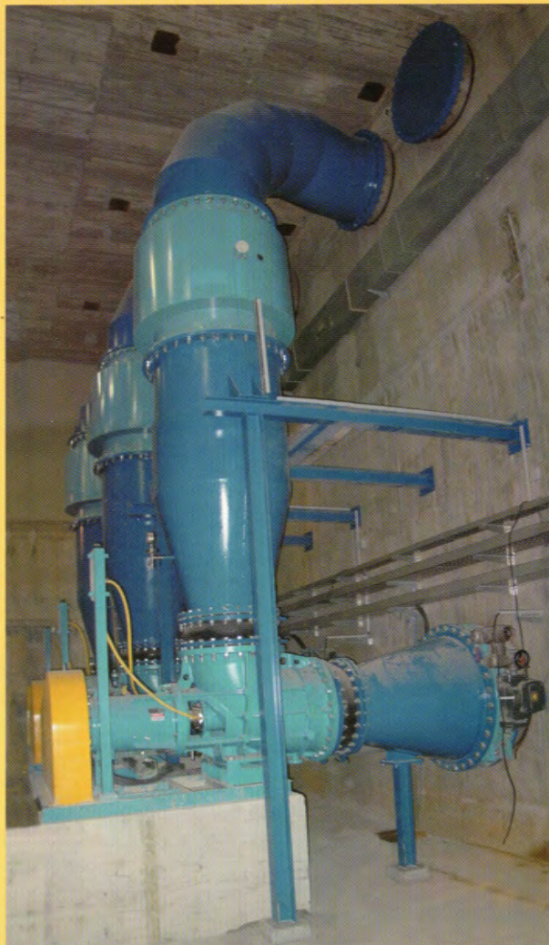
Bombeo intermedio para 11'5 m 3 /seg.
