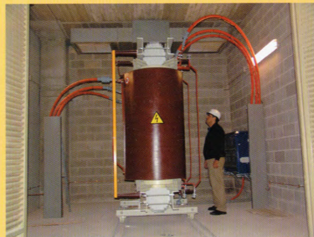
25 Mw. de potencia en transformadores
