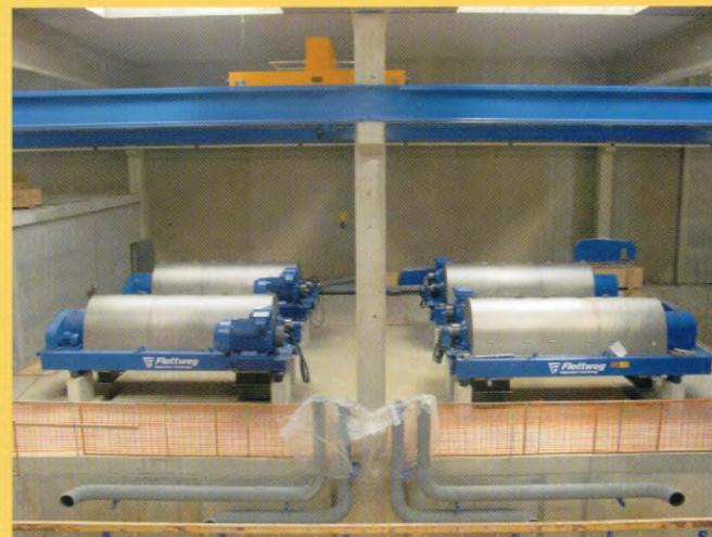
4 centrífugas de 225 m 3 /h
