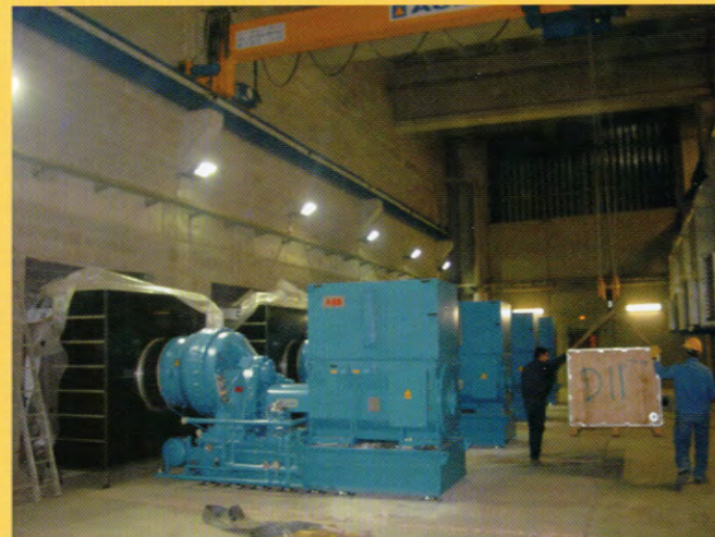
4 turbocompresores de 1.200 Kw.
