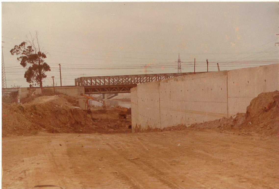
Fotografía 11. Obras de Encauzamiento de la Margen Derecha, Aguas Abajo del Puente de RENFE.
