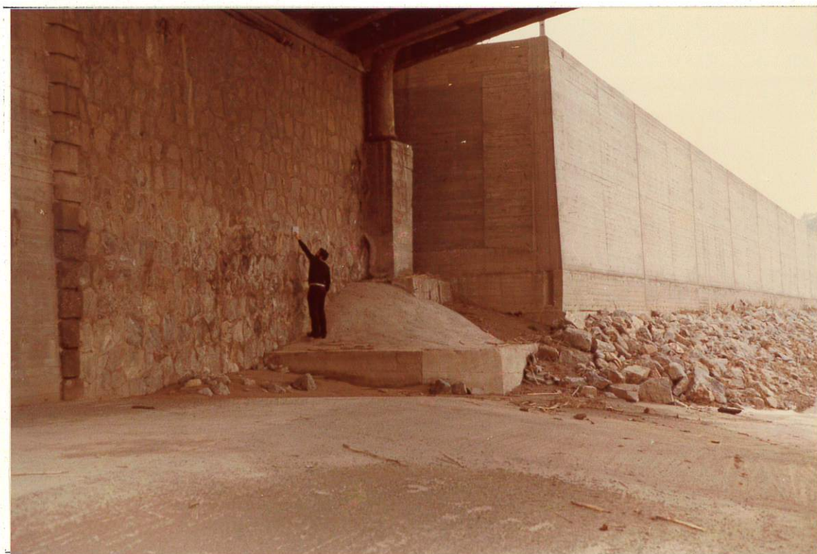
Fotografía 4. Estribo Derecho del Puente de la Carretera C-245, de Sant Boi de Llobregat a Cornellá de Llobregat.
