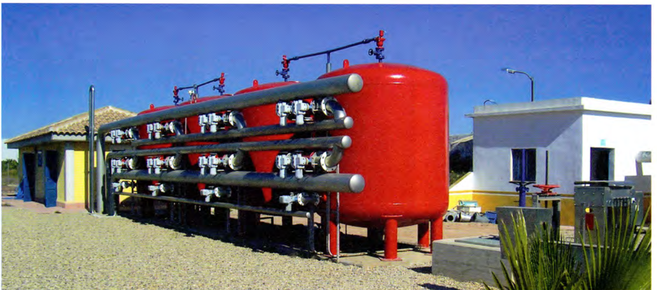
Equipos de filtración.
