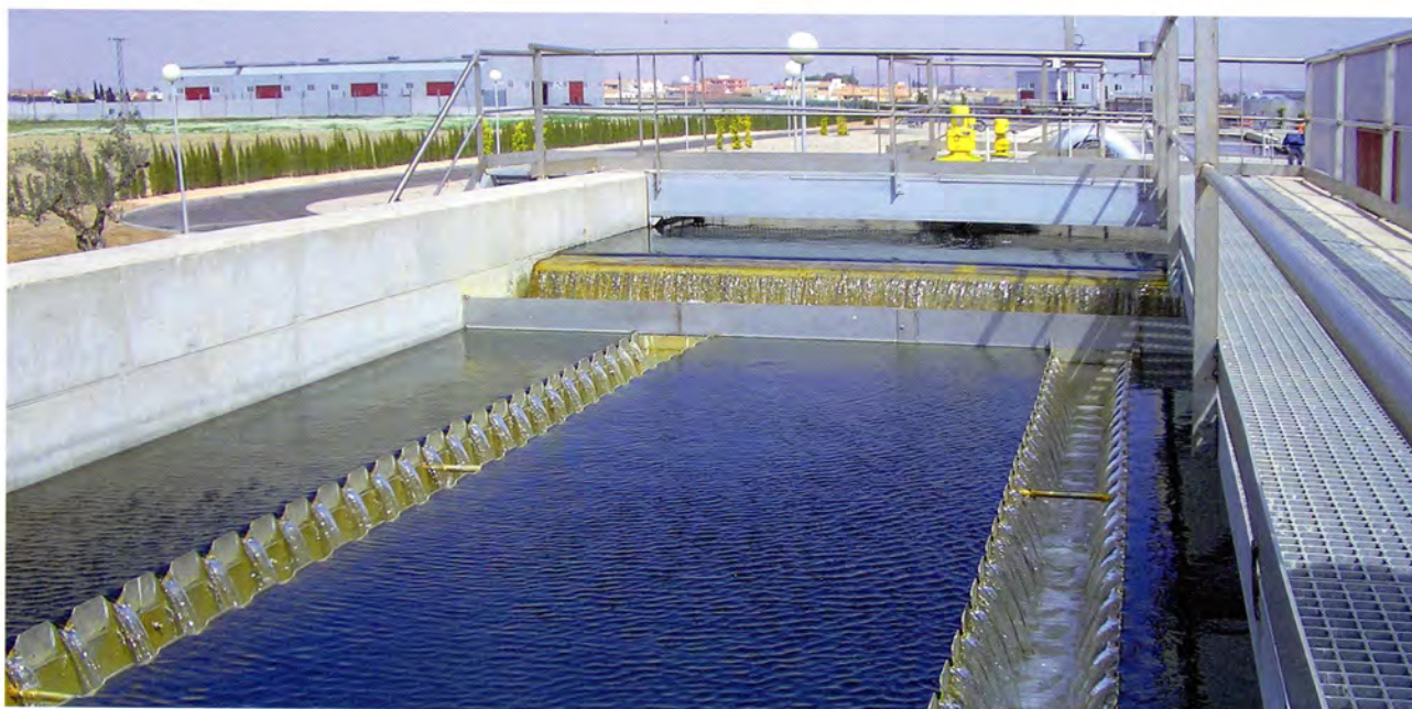
[9] Tratamiento Terciario ETAR Torre Pacheco.
