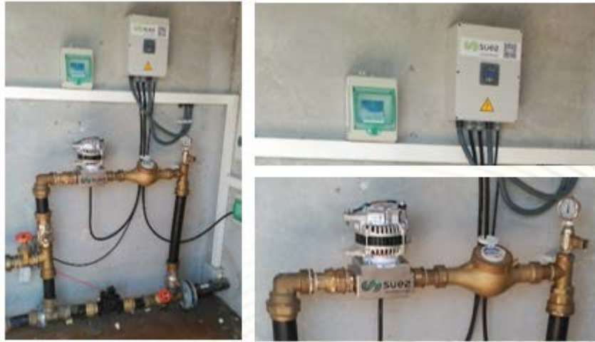
Picoturbina instalada en deposito
