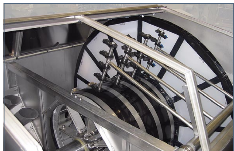
Figura 2. Equipo Hydrotech Discfilter HSF 2204/1 antes de la instalación.
