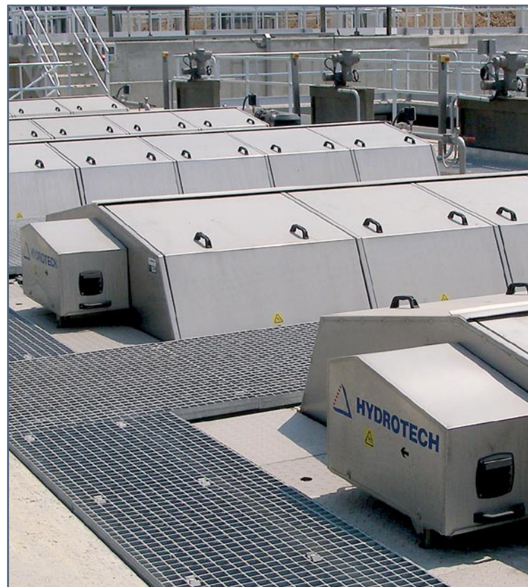
Figura 1. Vista de los sistemas Hydrotech existentes en la planta de regeneración de aguas de la EDAR Baix Llobregat.
