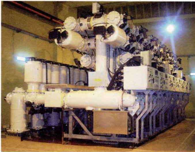
Equipos de transformación.
